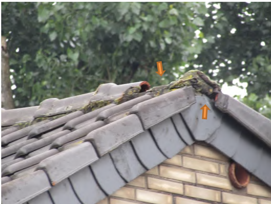
Foto 6: Wohnhaus, beschädigte Dacheindeckung
