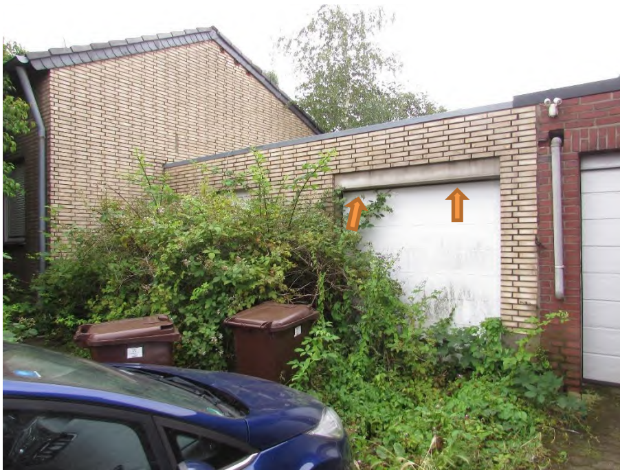
Foto 5: PKW-Garage, Metallsektionaltor nicht ordnungsgemäß beigearbeitet
