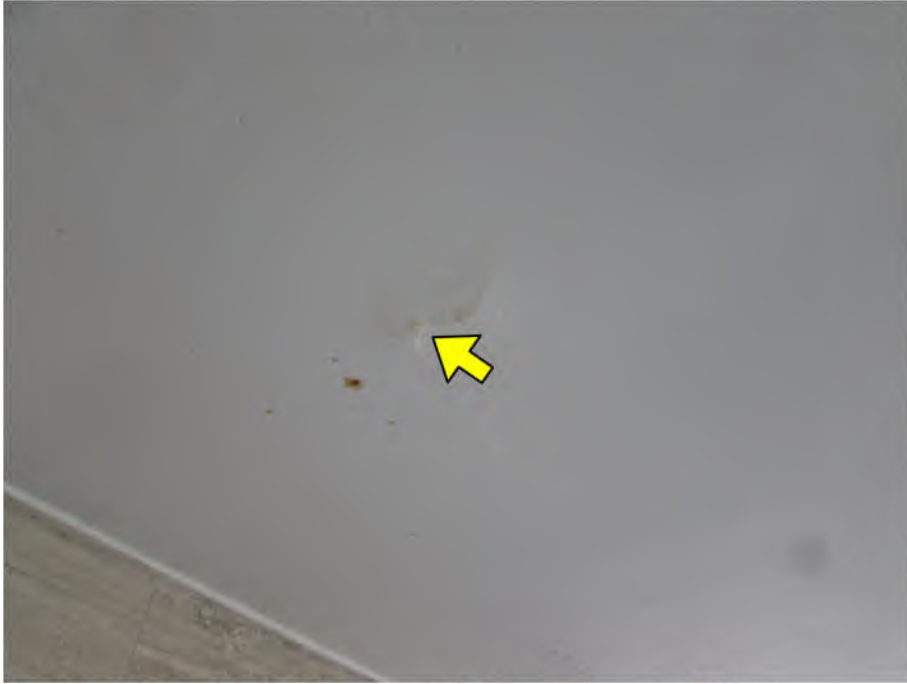
Foto 9: Balkon: Undichtigkeit am darüber gelegenen Balkon
