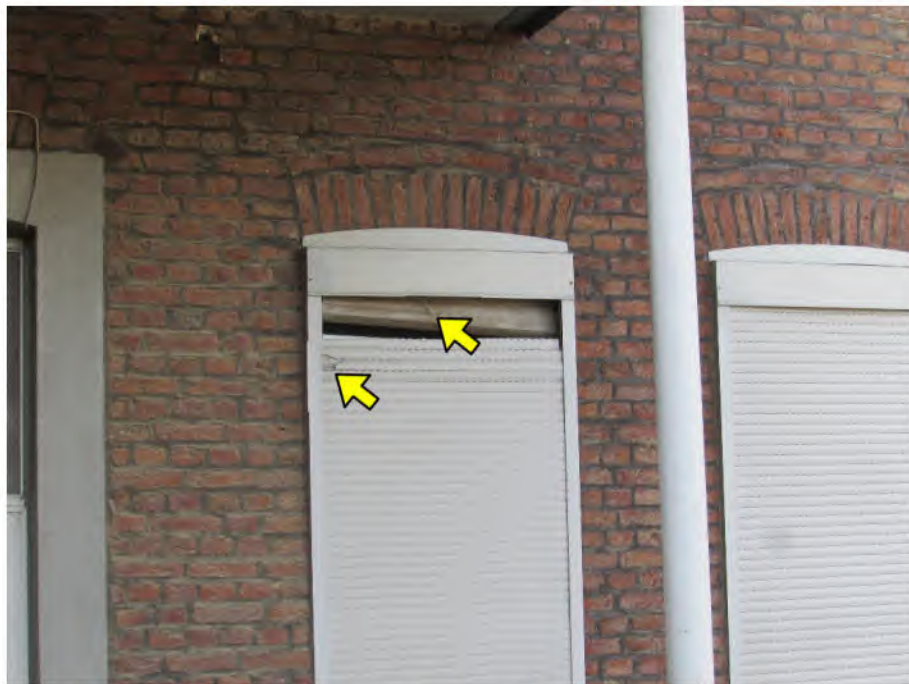
Foto 10: ehem. Klostergebäude: beschädigter Rollladen
