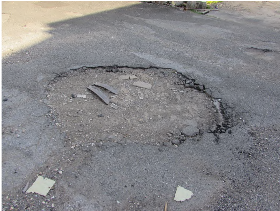
Foto 17: Feuerwehrezufahrt: beschädigte, asphaltierte Hofffläche
