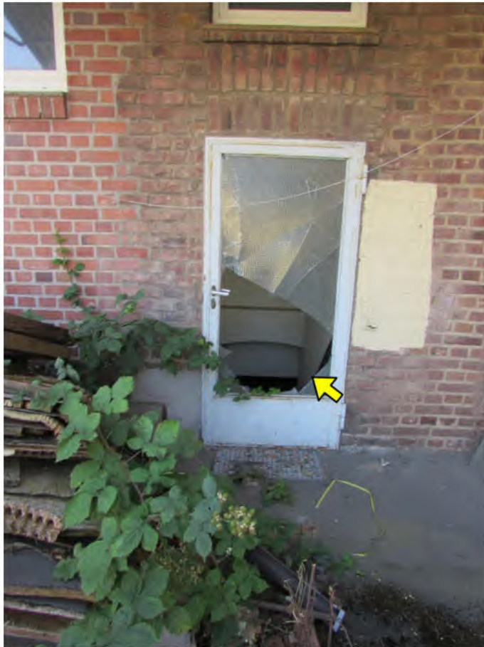
Foto 11: ehem. Klostergebäude: beschädigte Kelleraußentür
