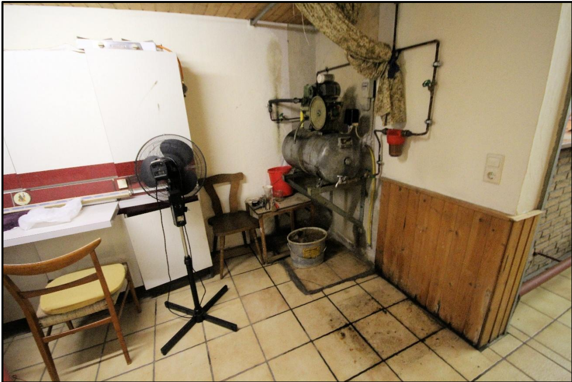
Bild 41: Raum „Bar“ im Kellergeschoss mit Gartenpumpe
