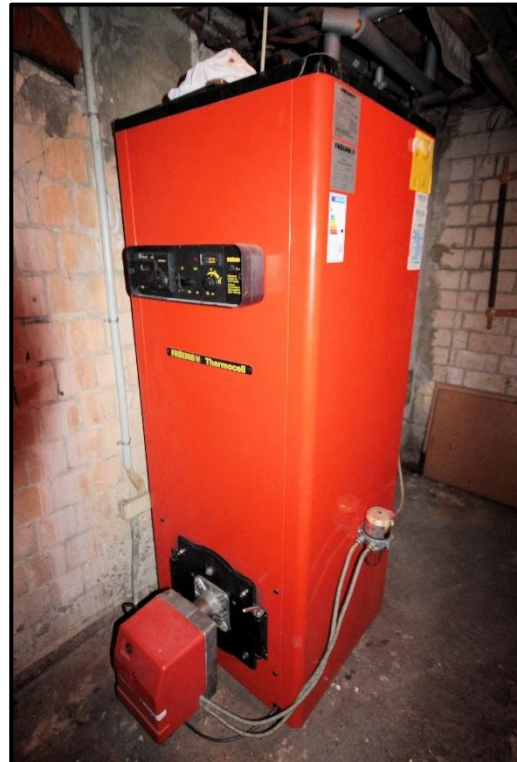
Bild 36: Öl-Heizung im Heizungskeller
