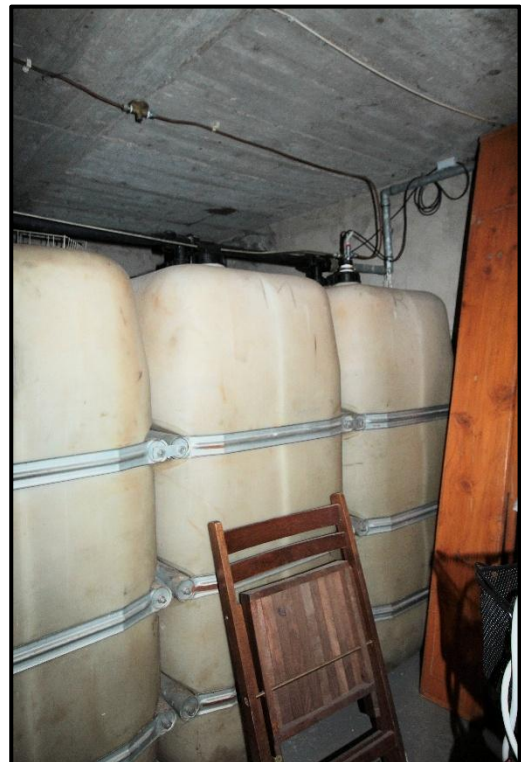
Bild 40: Batterietanks für Heizöl im Kellergeschoss
