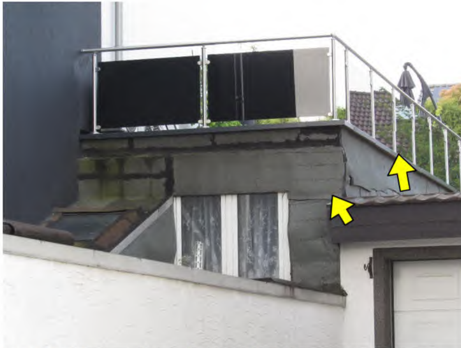
Foto 5: Dachterrasse der zu bewertenden Wohnung Nr. 2: bis an die Grundstücksgrenze reichende Dachterrasse, tlw. fehlende Glasausfachung des Dachterrassengeländers, provisorisch mit Bitumenbahnen abgeklebte Fassade
