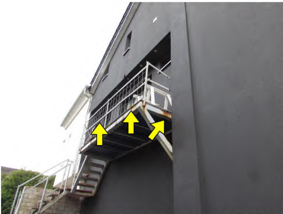
Foto 4: Zugangstreppe (Sondernutzungsrecht) zu der zu bewertenden Wohnung Nr. 2: Korrosion an der Metallkonstruktion, tlw. provisorisch erstelltes Geländer
