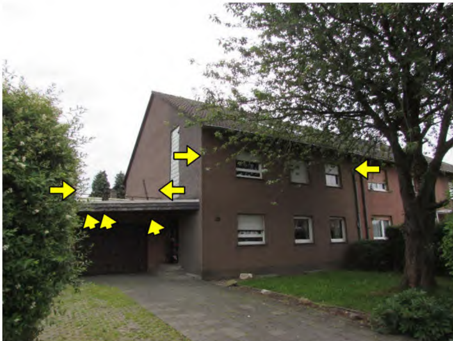
Foto 2: zu bewertende Wohnung Nr. 2, Dachterrasse oberhalb der Garage (Sondernutzungsrecht): beschädigte Asbestzementplatten der seitlichen Vordach-Verkleidung, fleckige, tlw. morsche Holzverkleidung der Vordach-Untersicht
