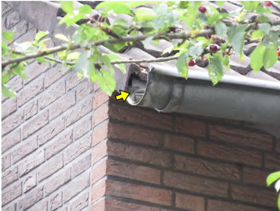
Foto 3: Wohnhaus, beschädigte Dachentwässerung
