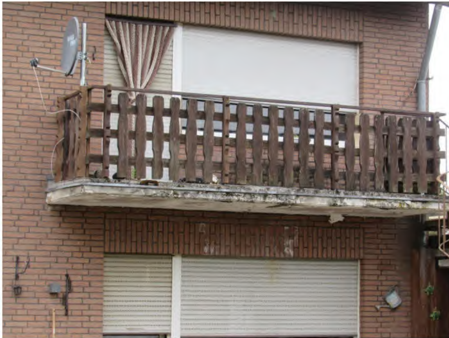
Foto 7: rückwärtige Ansicht: schadhafte Balkonplatte, verwittertes Geländer
