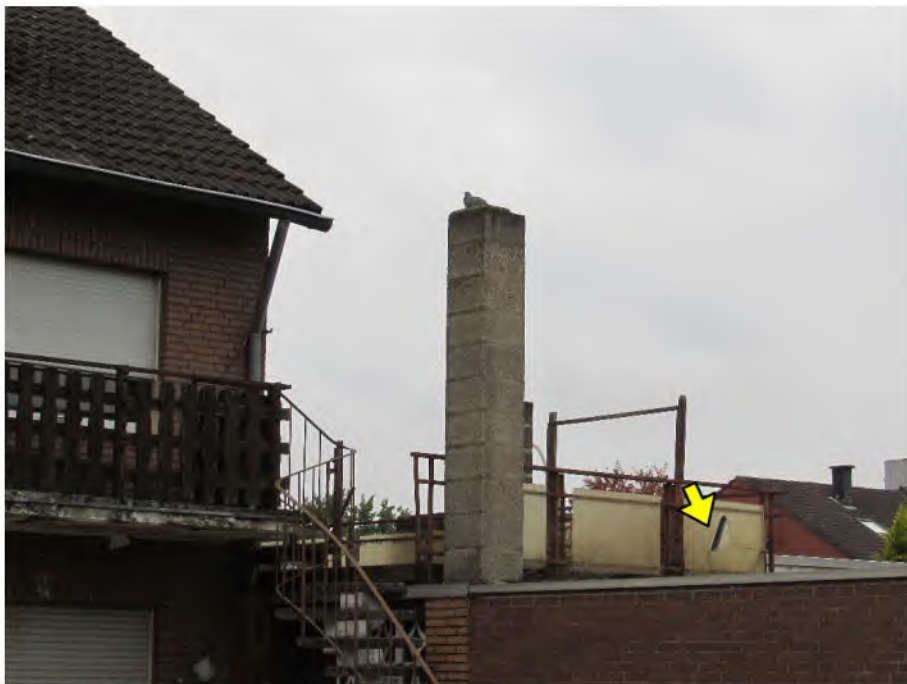
Foto 8: Dachterrasse oberhalb der Garage (Sondernutzungsrecht): tlw. korrodiertes Geländer, tlw. beschädigte Kunststoffausfachung
