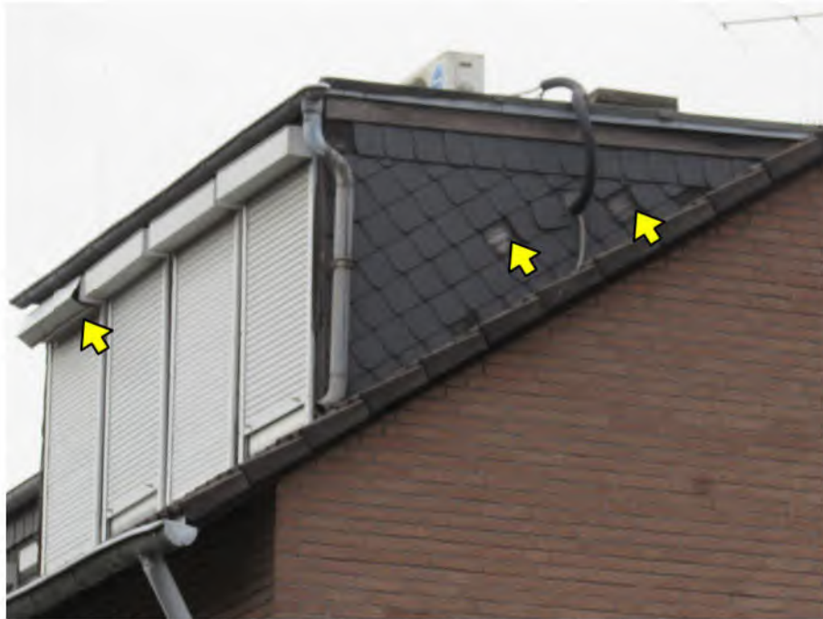
Foto 5: nicht ordnungsgemäßer Rolladenkasten, beschädigte, tlw. fehlende Verkleidung der Dachgaube
