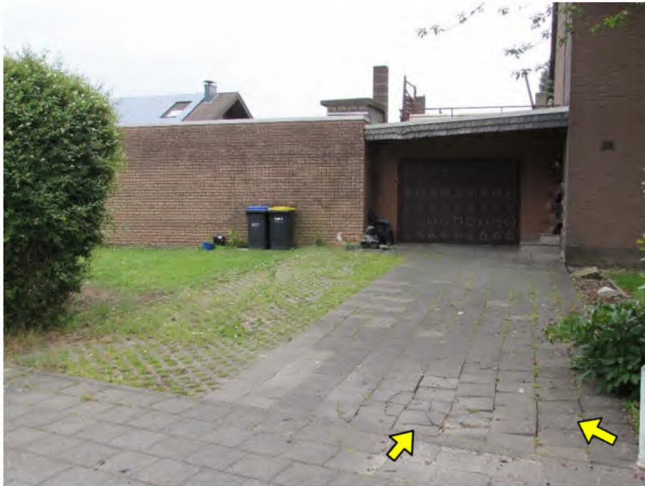
Foto 9: Zufahrt (links, Sondernutzungsrecht zugunsten der EG-Einheit 1) und Zugang (rechts): beschädigte, unebene Befestigung
