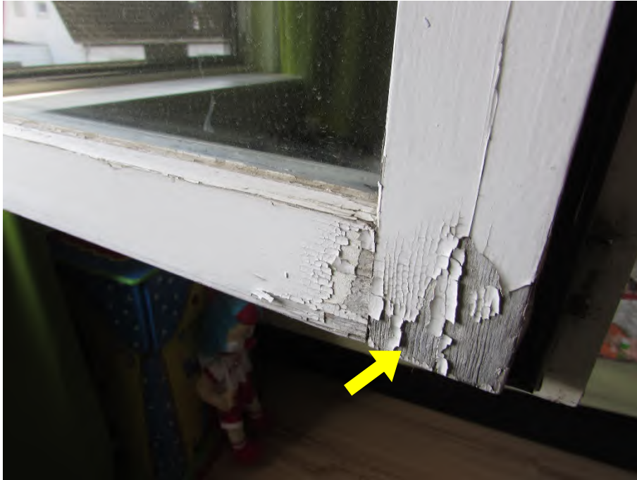
Foto 7: alte Holzfenster, abblätternder Farbanstrich
