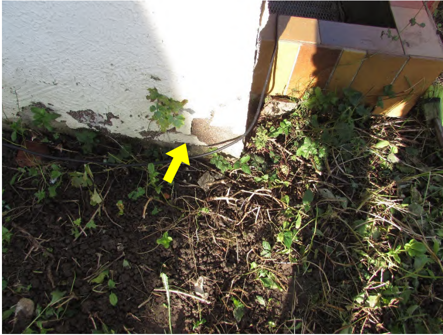
Foto 9: PKW-Garage: Feuchtigkeit im Fassadenbereich
