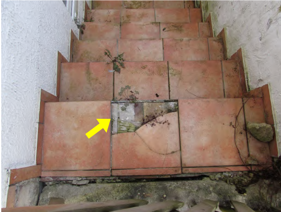
Foto 3: Kelleraußentreppe: beschädigter Fliesenbelag
