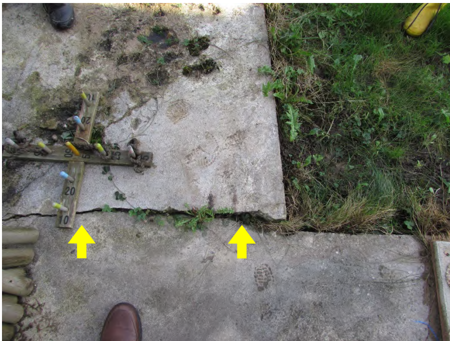
Foto 14: beschädigter, betonierter Gartenweg
