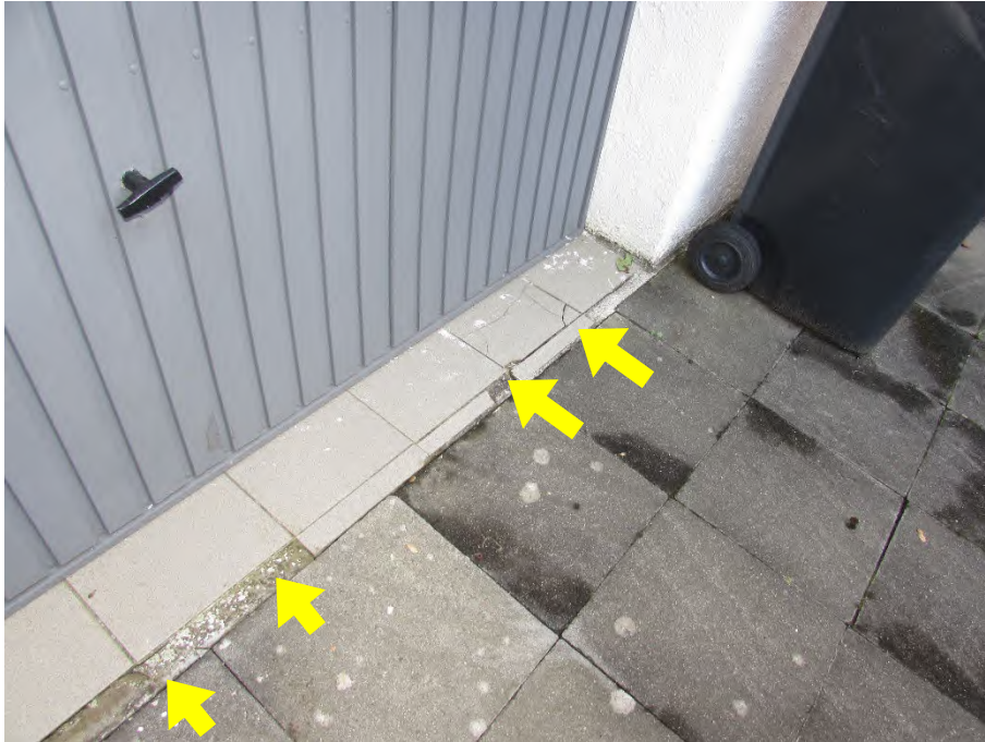
Foto 11: PKW-Garage: schadhafte Bodenfliesen im Zufahrtsbereich
