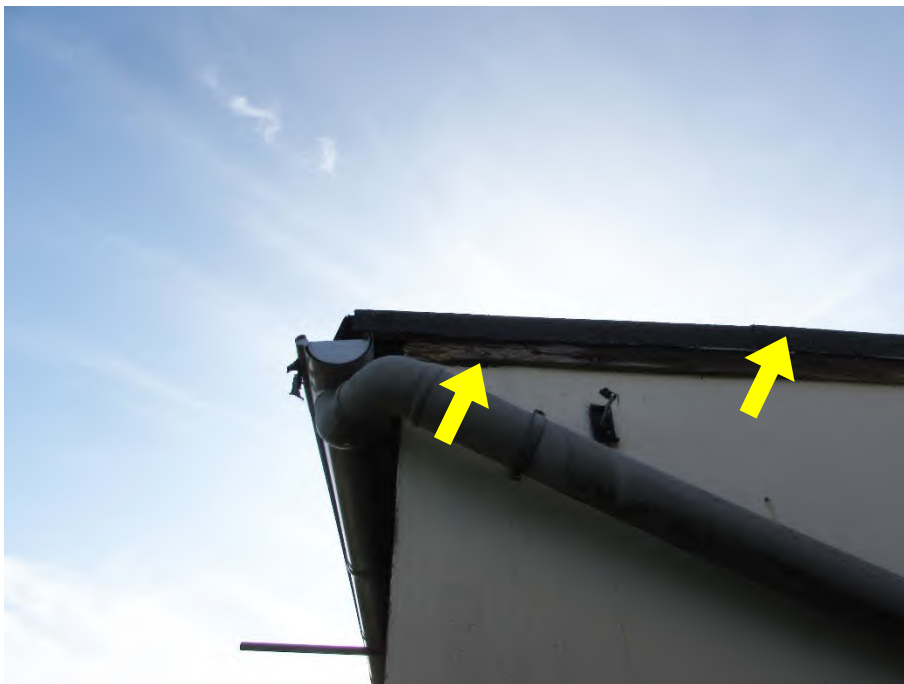
Foto 10: PKW-Garage: nicht ordnungsgemäße Dachabdichtung/Dachabschluss, verwitterte seitliche Holzverkleidung
