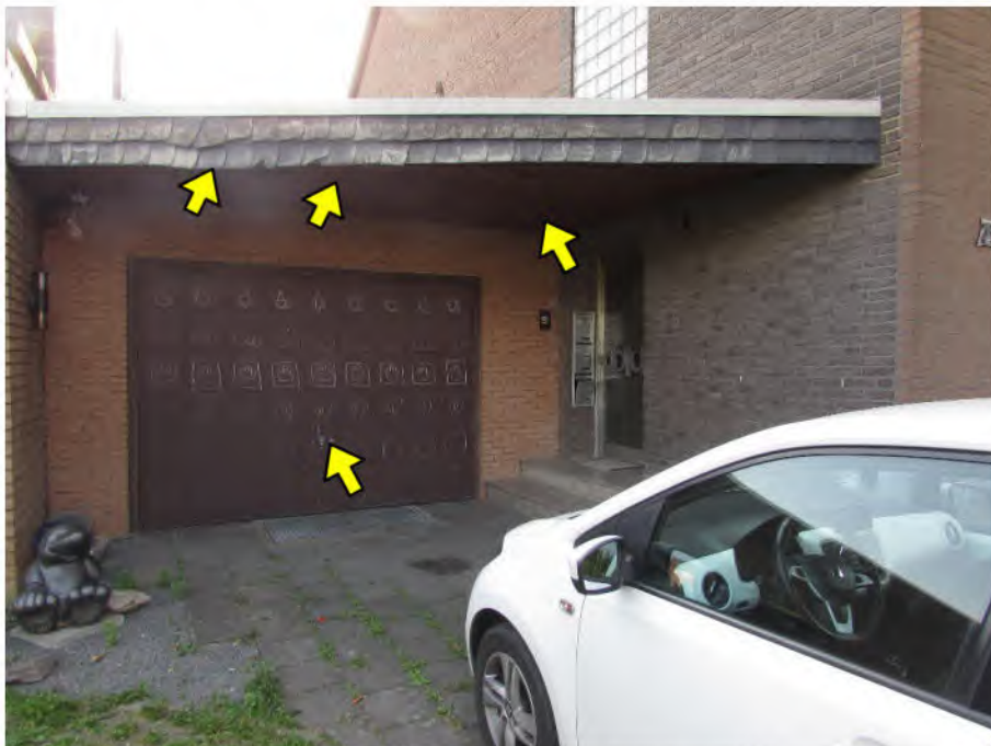
Foto 2: PKW-Garage Nr. 1: fehlender Garagentorgriff Hauseingang: beschädigte Asbestzementplatten der seitlichen Vordach-Verkleidung
