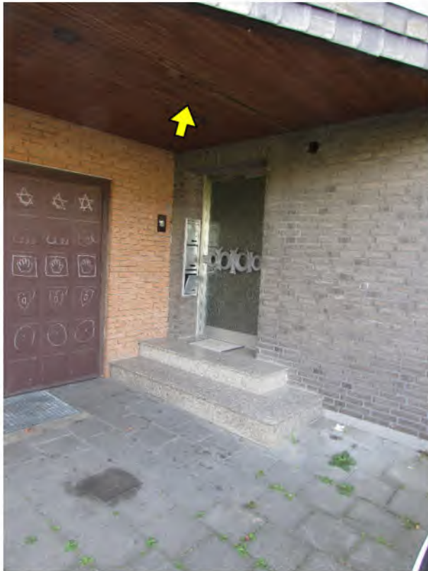
Foto 3: Hauseingang: fleckige, tlw. morsche Holzverkleidung der Vordach-Untersicht
