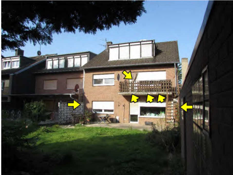
Foto 5: rückwärtiger Grundstücksbereich, Wohnung Nr. 1, Gartenfläche (Sondernutzungsrecht), schadhafte Balkonplatte und verwittertes Balkongeländer im Obergeschoss
