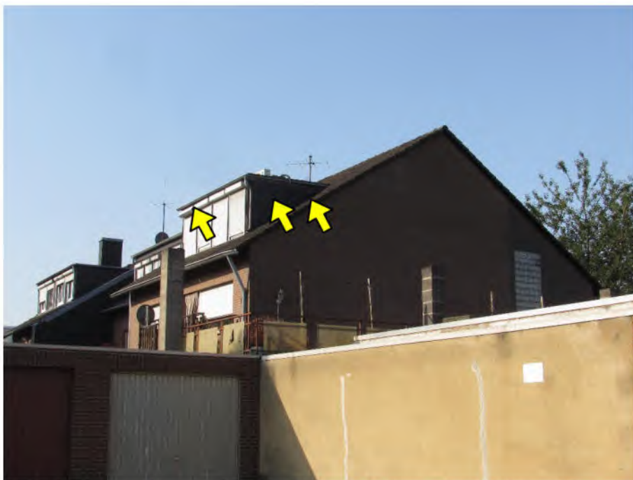
Foto 4: nicht ordnungsgemäßer Rolladenkasten, beschädigte, tlw. fehlende Verkleidung der Dachgaube
