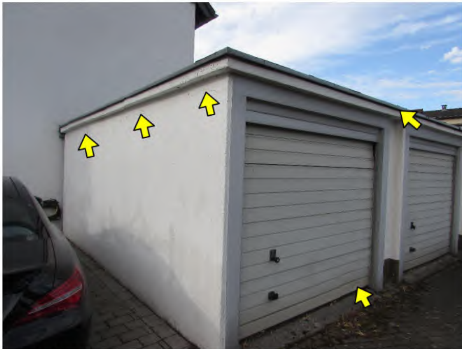
Foto 1: PKW-Garage: Risse im Beton, Beule im Tor
