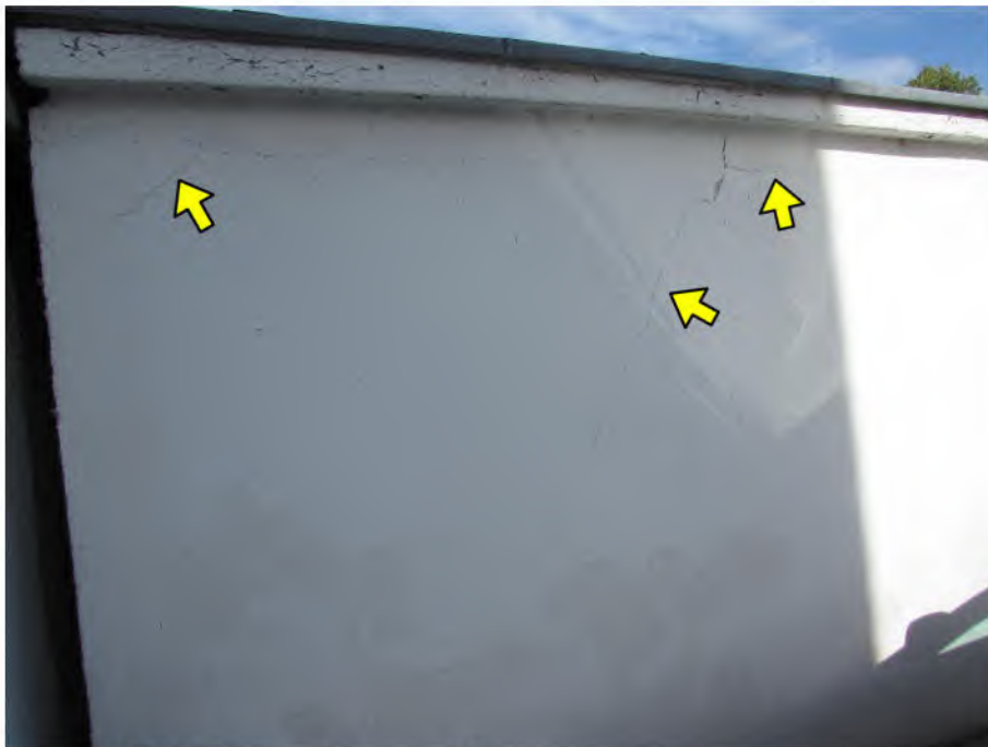
Foto 2: PKW-Garage: Risse im Beton
