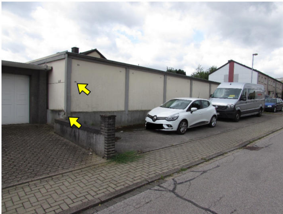
Foto 12: Garagenhof, Ansicht von der "Schumannstraße": Beschädigungen im Fassadenbereich
