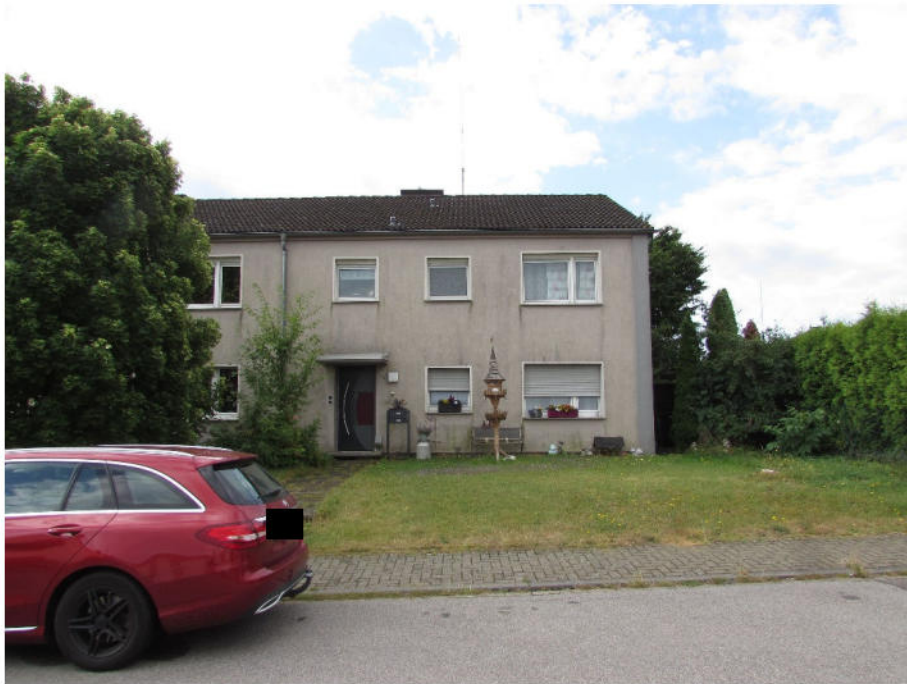
Foto 1: Flurstück 647 : Wohnhaus: fleckige Fassade
