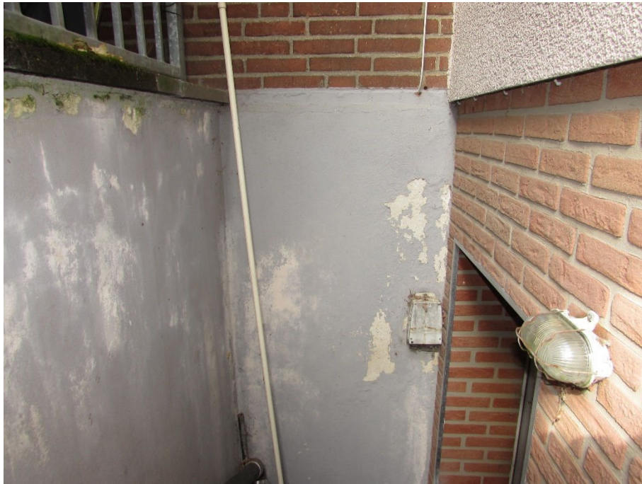
Foto 5: Kelleraußentreppe: Feuchtigkeit im Stützwandbereich
