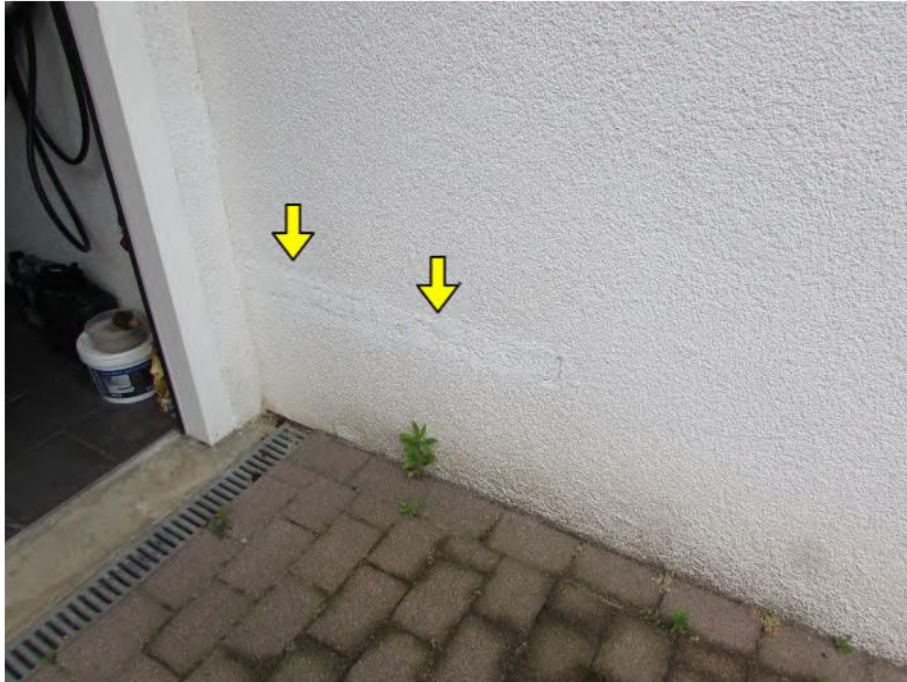
Foto 7: Wohnhaus: nicht ordnungsgemäß beigearbeitete Fassade im Garagenzufahrtbereich
