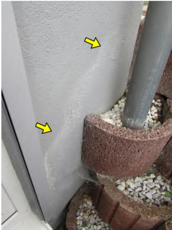
Foto 3: Wohnhaus: Feuchtigkeit im Fassadenbereich seitlich des Hobbykellerfensters
