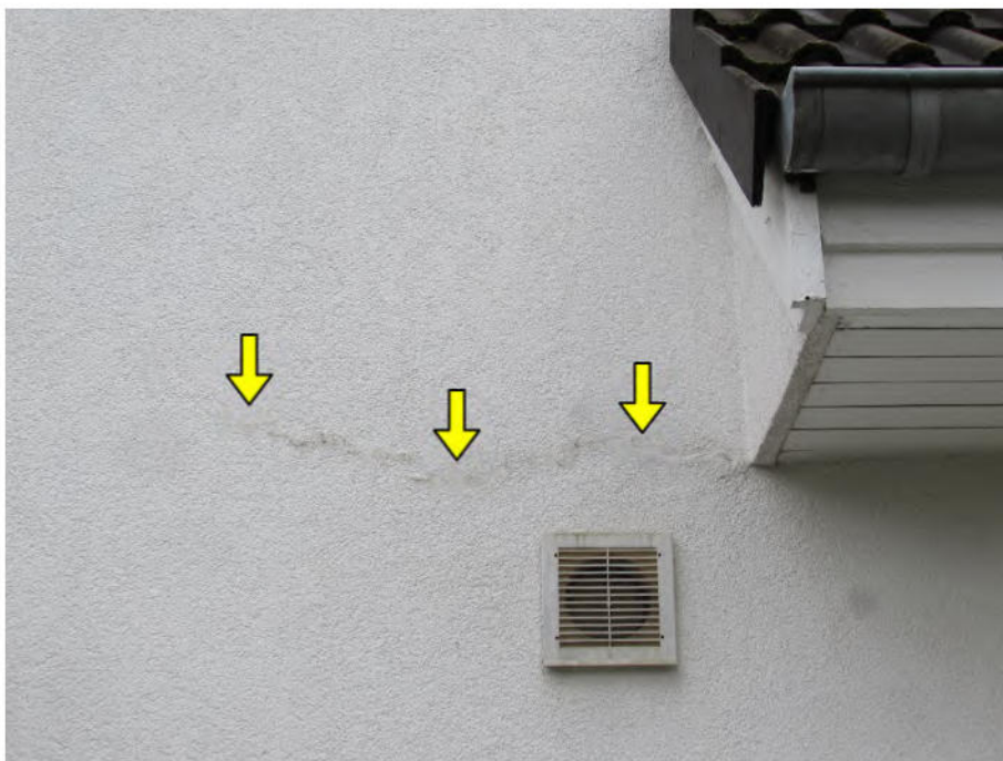
Foto 4: Wohnhaus: Riss im straßenseitigen Fassadenbereich
