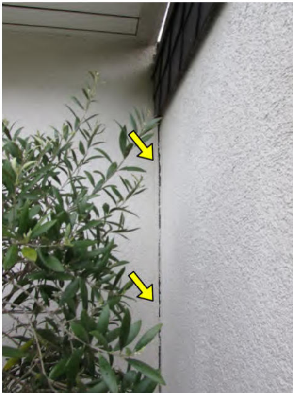
Foto 10: geöffnete Fuge zwischen Wohnhaus und Garage
