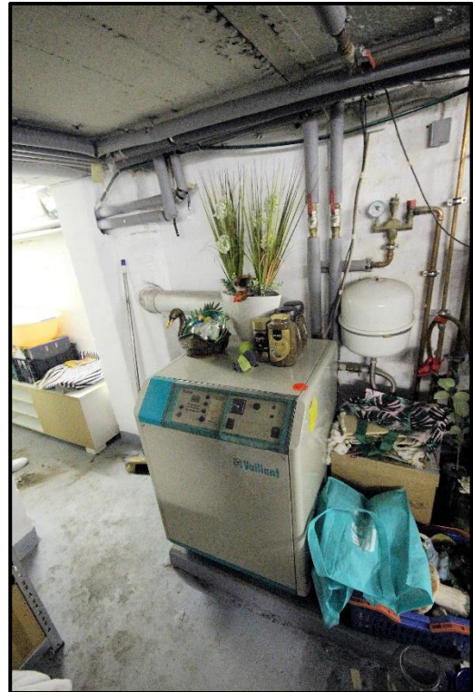
Bild 37: Gas-Heizungsanlage Fabrikat Vaillant im Kellergeschoss
