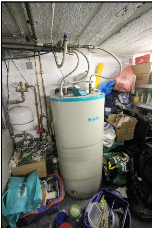
Bild 38: Warmwasserspeicher der Heizungsanlage Fabrikat Vaillant
