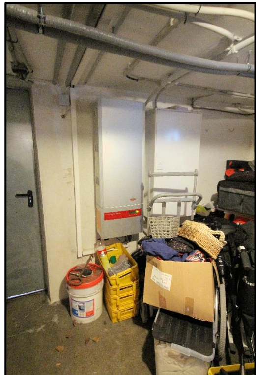
Bild 16: Zählerschrank und Gleichrichter der Photovoltaikanlage im KG
