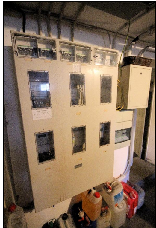
Bild 21: Zähler und Sicherungsschränke für die Wohneinheiten
