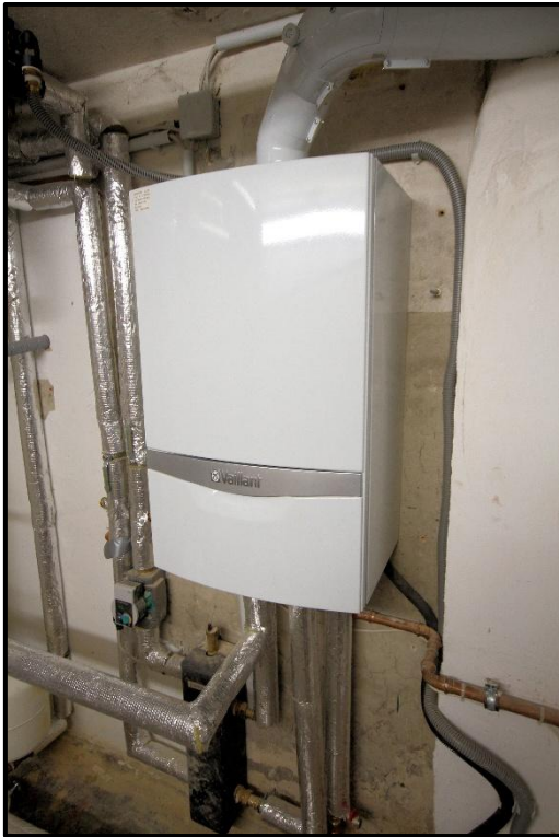
Bild 17: Gas-Brennwerttherme im KG
