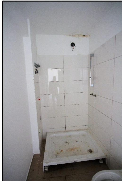
Bild 26: wie vor, mit Feuchteschaden und deutlicher Schimmelbildung
