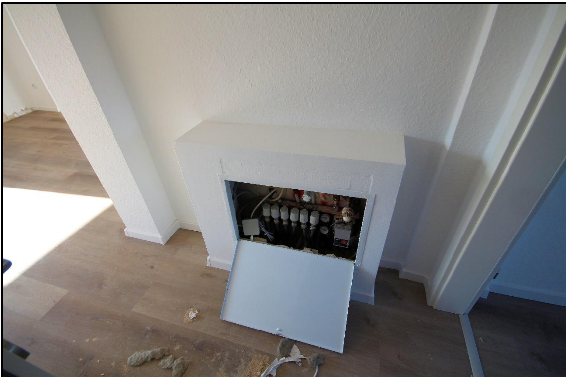
Bild 23: Verteiler der Fußbodenheizung im zweiten Flur der WE Nr. 7
