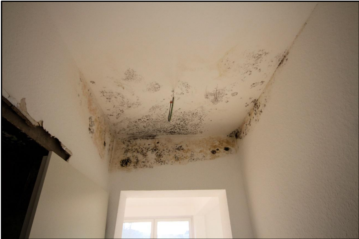
Bild 24: Feuchteschaden mit deutlicher Schimmelbildung im zweiten Flur der WE Nr. 7
