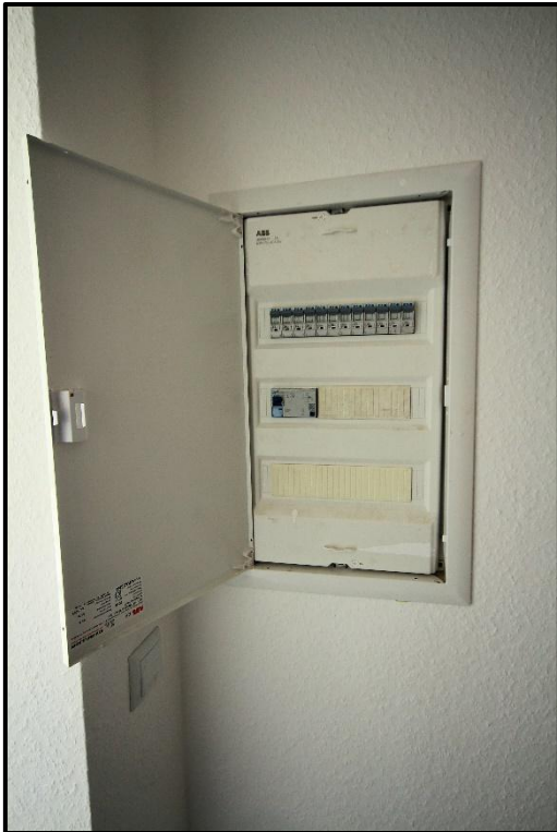
Bild 21: Sicherungskasten mit FI-Schalter im Flur der WE Nr. 7
