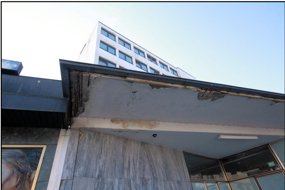
Bild 8: Betonkorrosion am Vordach
