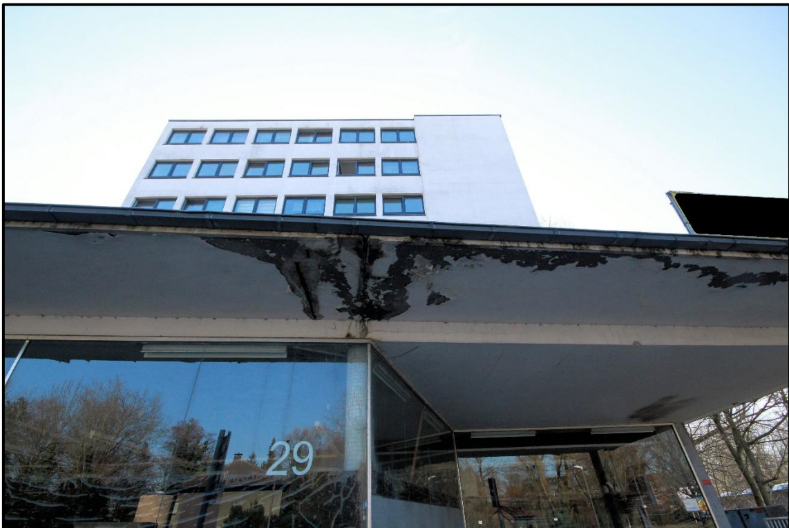
Bild 10: Betonkorrosion am Vordach
