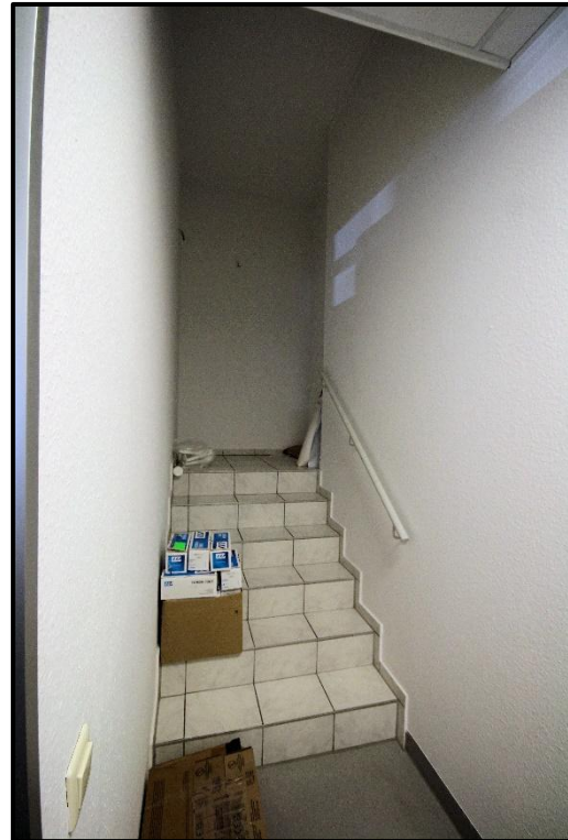
Bild 19: Treppe zum OG (nachträglich verschlossen)
