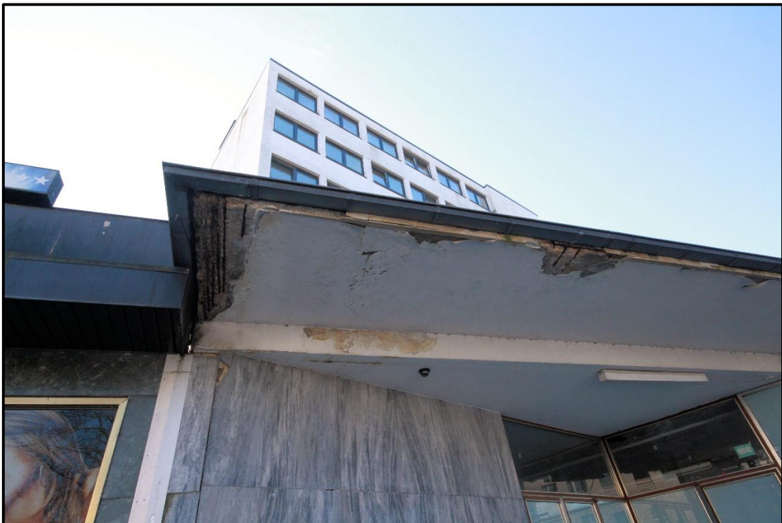
Bild 8: Betonkorrosion am Vordach
