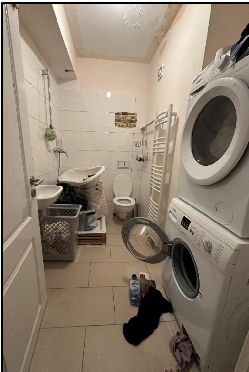
Bild 21: Bad der WE Nr. 8 mit Feuchteschaden an der Decke
