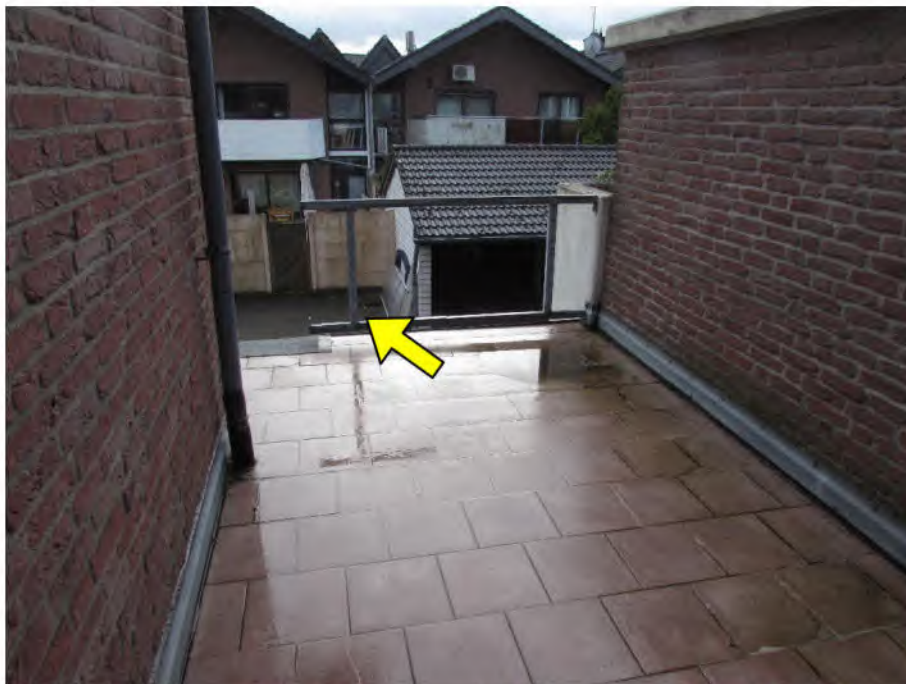
Foto 12: Wohnung 2 (Dachgeschoss), Dachterrasse: tlw. fehlendes Geländer
