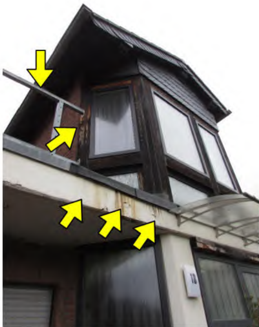
Foto 2: Feuchtigkeit im seitlichen Dachterrassenbereich, verwitterte Holzkonstruktion des Treppenhaus-Erkers, tlw. fehlendes Dachterrassengeländer
