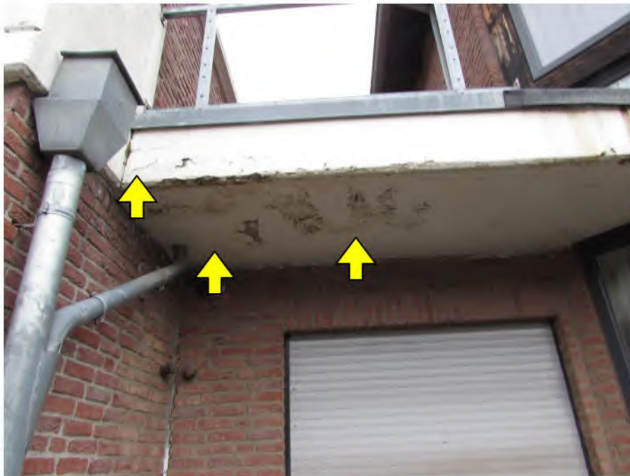
Foto 4: Feuchtigkeit und Betonbeschädigungen im Dachterrassenbereich
