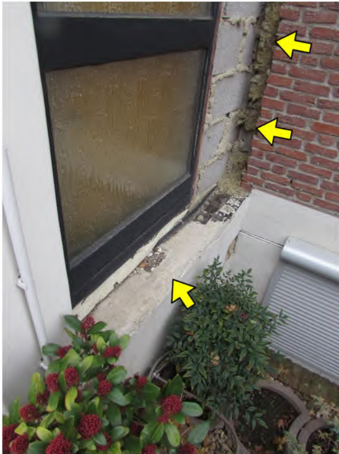
Foto 7: Hauseingangsbereich: Fehlende Verklankerung/Verkleidung und Außenfensterbank im Treppenhaus-Erkerfassadenbereich
