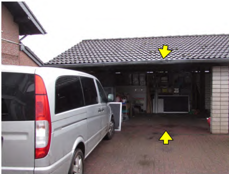
Foto 14: Carport: verbeulte Dachentwässerung Sondernutzungsrecht an dem rechten Stellplatz
