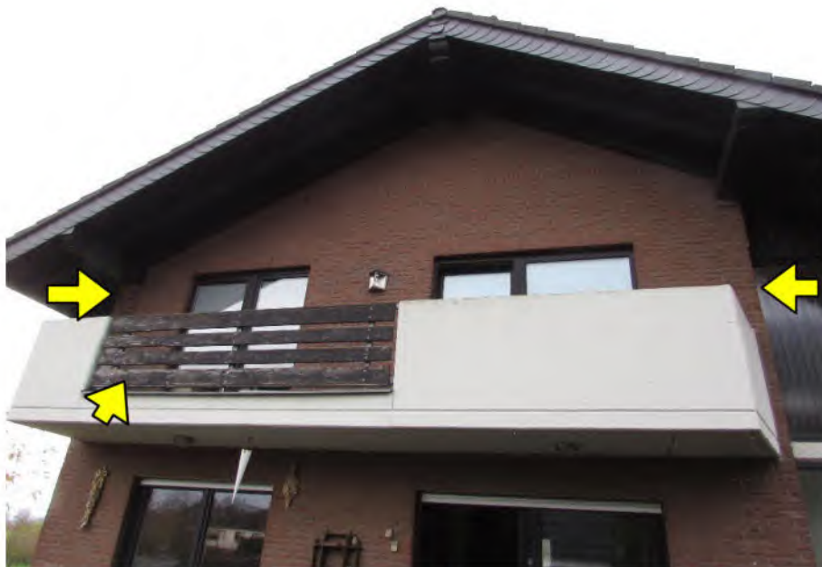
Foto 8: Wohnhaus, rückwärtige Ansicht: verwittertes Balkongeländer, zu bewertende Wohnung Nr. 2
