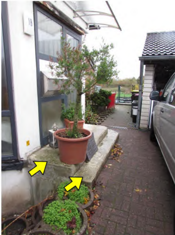
Foto 5: Hauseingangstreppe: fehlender Belag
