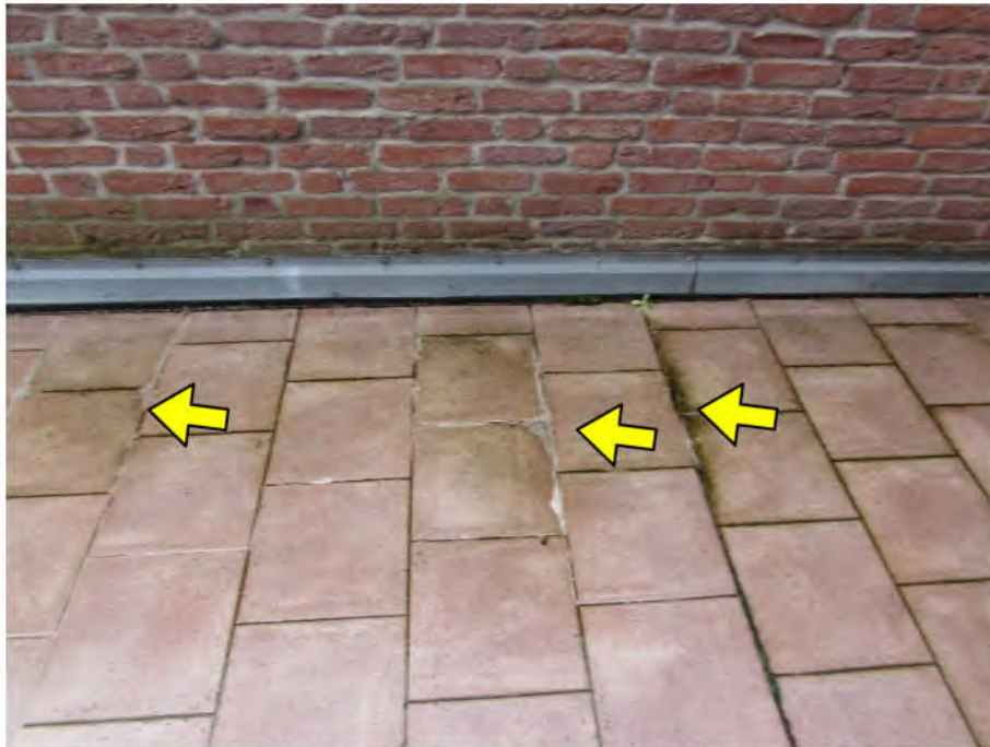
Foto 13: Wohnung 2 (Dachgeschoss), Dachterrasse: schadhafte Fliesen
