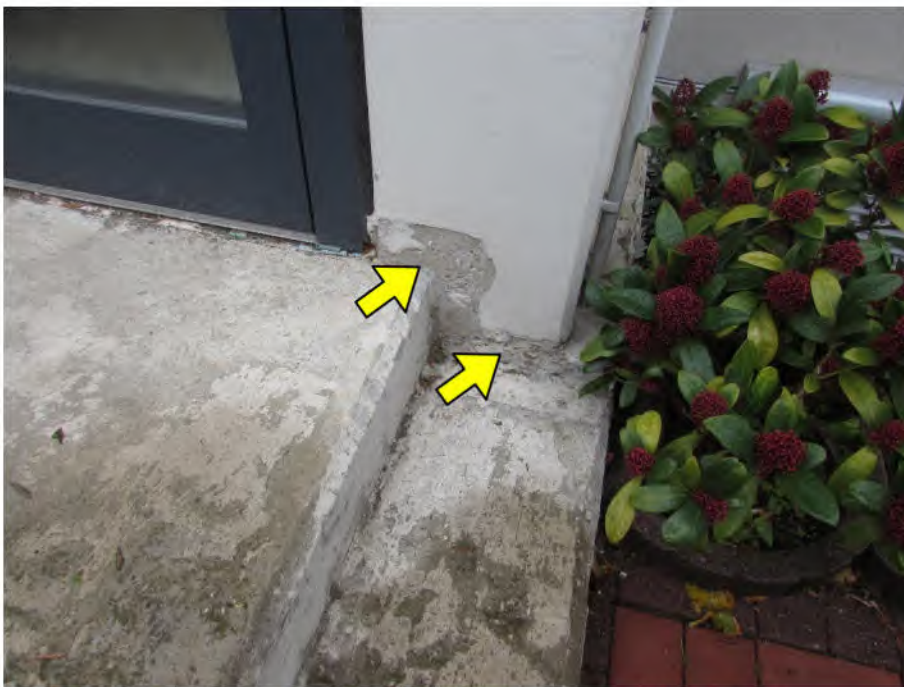
Foto 6: Hauseingangsbereich: Beschädigungen im Wohnhaus-Fassadenbereich
