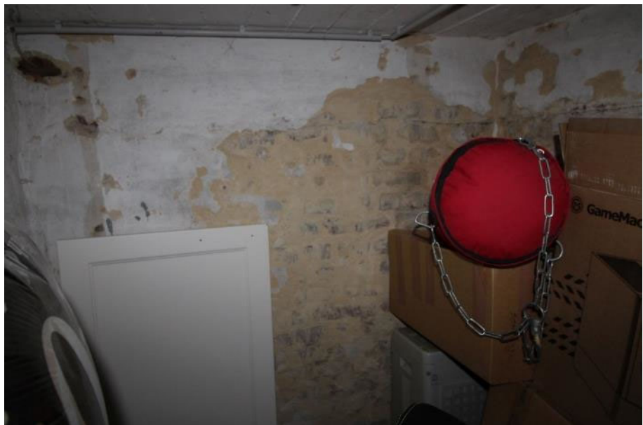
Sicht auf Feuchte- schäden am Keller- mauerwerk / KG.
