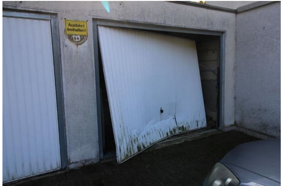
Sicht auf das beschädigte Tor der rechten Garage.
