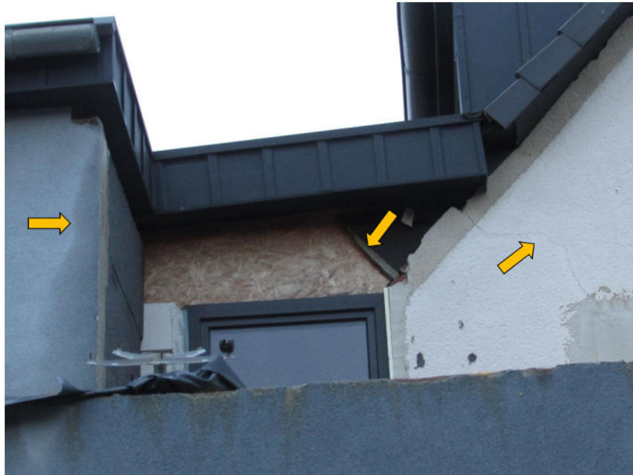
Foto 9: Wohnhaus, Risse in der Fassade, fehlender Außenputz/fehlende Verkleidung des Anbaus, Feuchtigkeit
