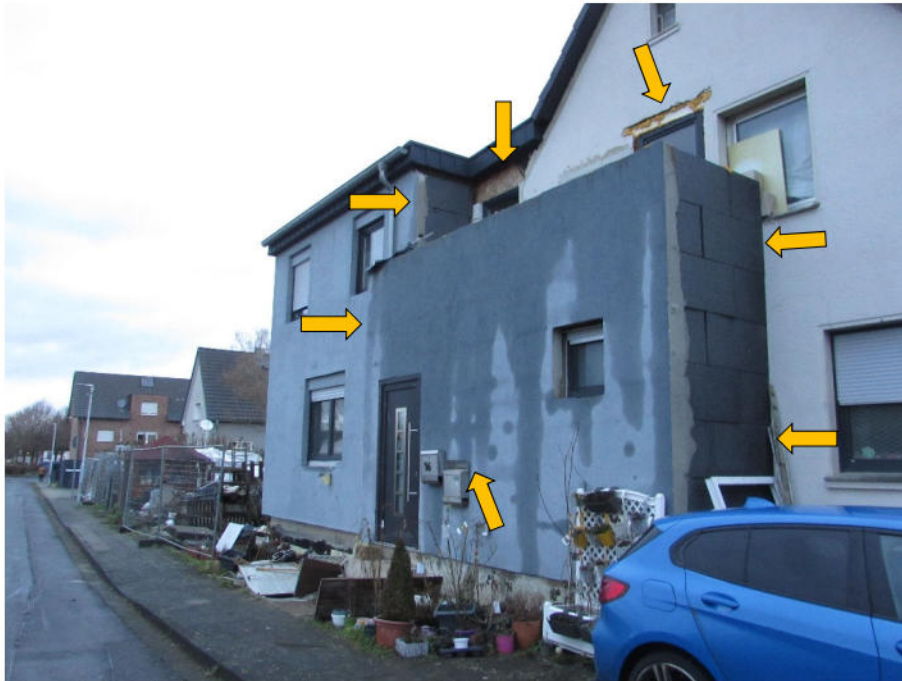
Foto 7: Wohnhaus mit Anbau und Hauseingangsanbau, Straßenansicht, z.T. fehlender Außenputz, Feuchtigkeit, nicht ordnungsgemäß beigearbeitete Fenster
