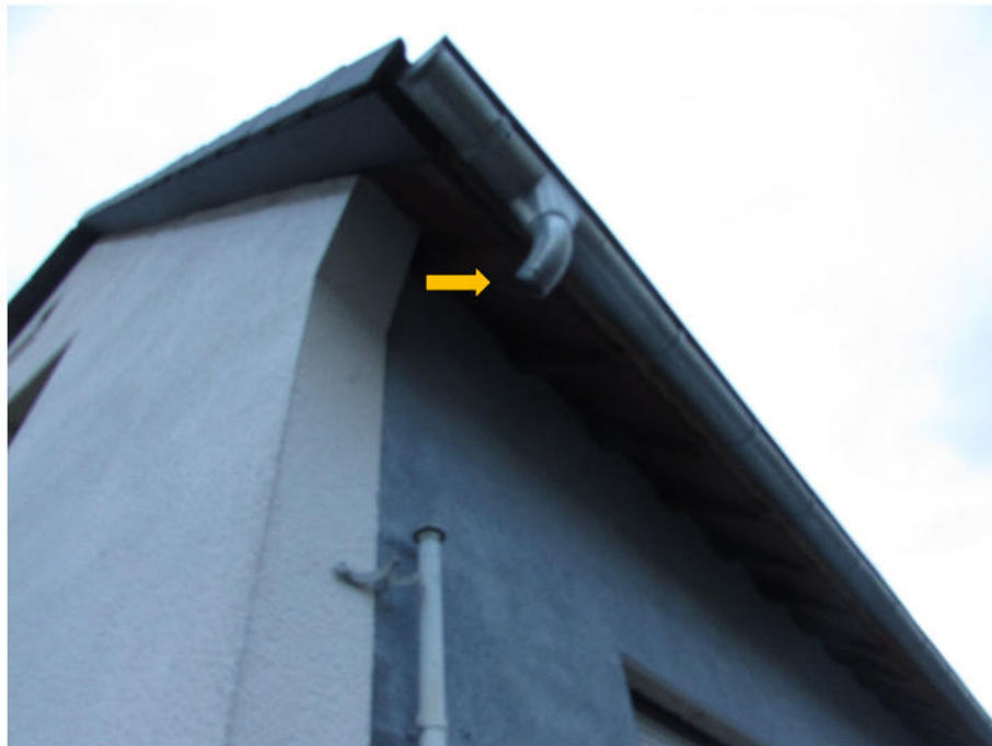
Foto 4: Wohnhaus (Altbau), fehlendes Fallrohr
