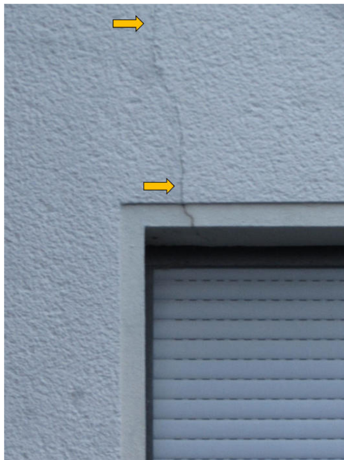
Foto 6: Wohnhaus, Risse in der Fassade
