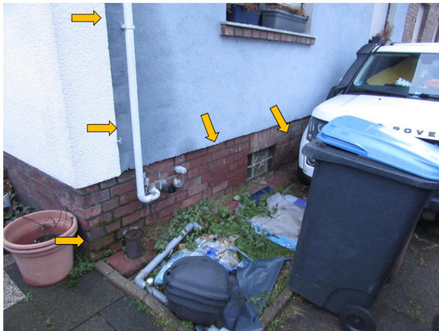
Foto 5: Wohnhaus (Altbau), Feuchtigkeit in der Fassade und im Sockelbereich
