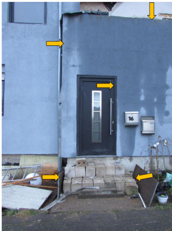
Foto 8: Wohnhaus, Hauseingang, provisorische Hauseingangstreppe, Feuchtigkeit
