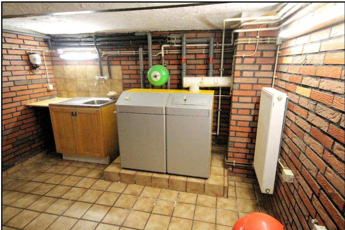
Bild 37: Gas-Heizungsanlage im Kellergeschoss
