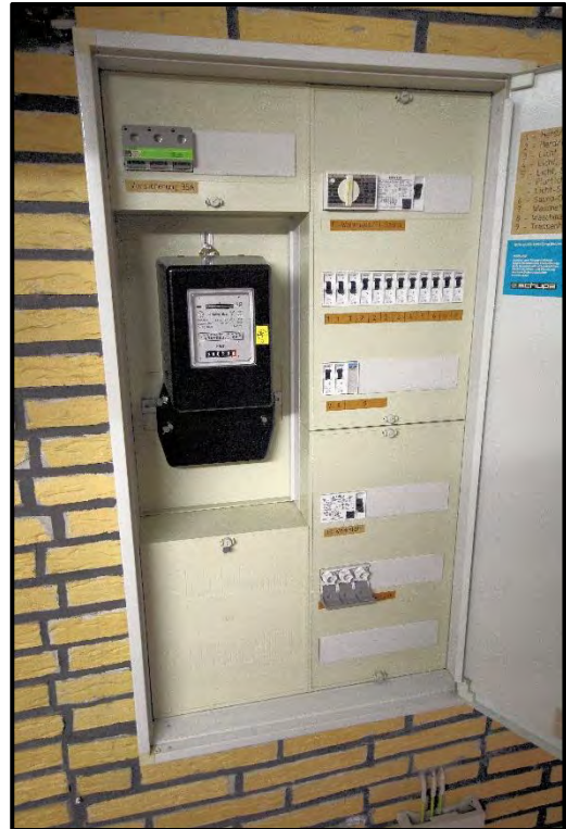
Bild 36: Zähler- und Sicherungsschrank im Kellerflur
