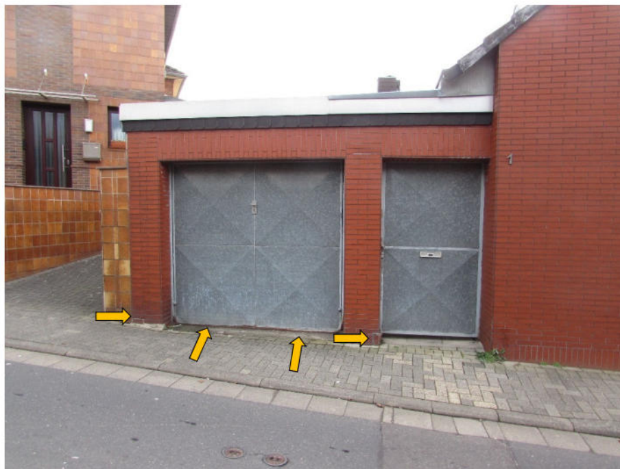
Foto 4: PKW-Garage, Straßenansicht, korrodiertes Metallschwinger, Schäden an der Fassade
