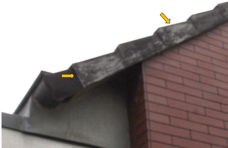
Foto 3: Wohnhaus, verwitterter Dachabschluss
