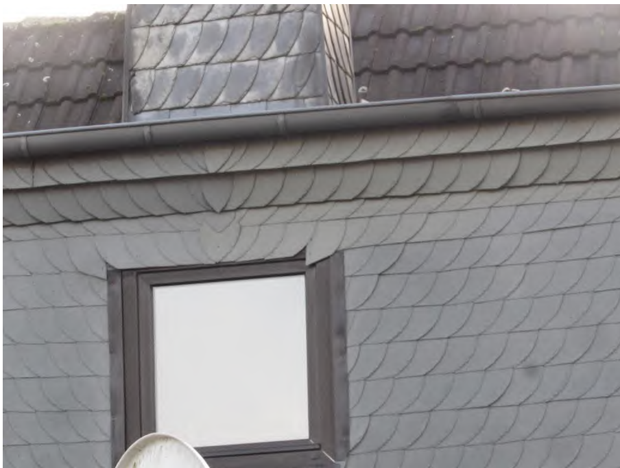
Foto 14: lose Verkleidung im Bereich der Dachgaube (Wohnhaus)
