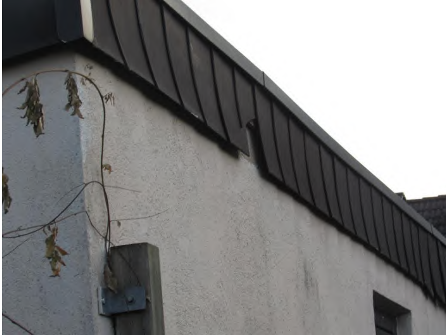
Foto 13: beschädigter Dachabschluss (Anbau II)
