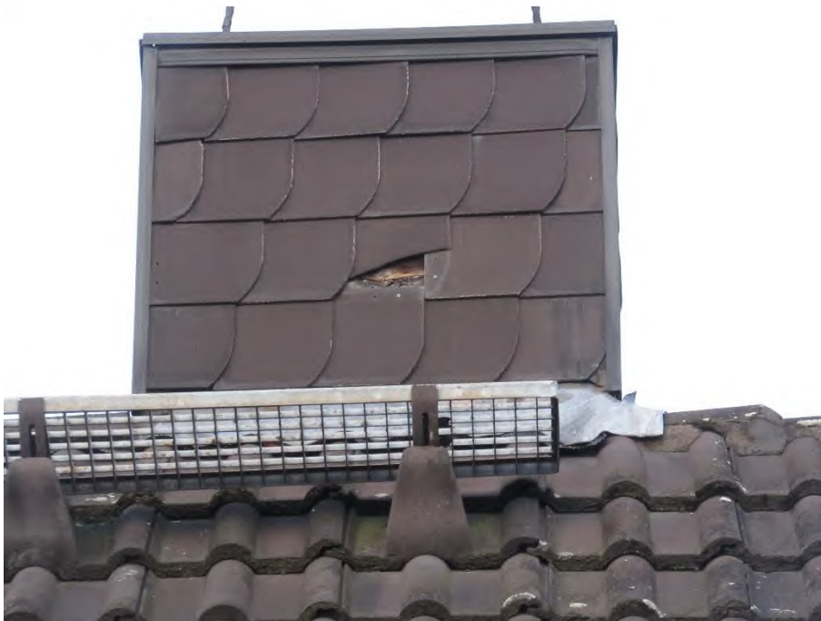
Foto 10: beschädigte Schornsteinverkleidung (Wohnhaus)
