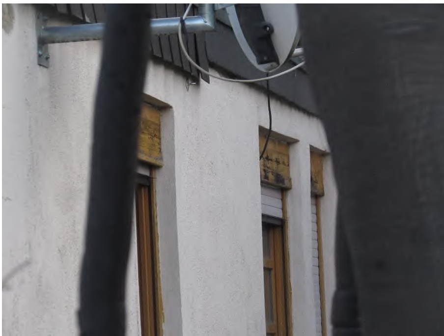
Foto 12: nicht ordnungsgemäß verbaute Rollladenkästen im Bereich des Anbaus II
