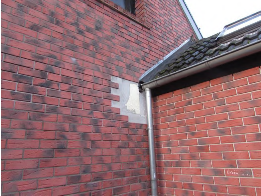
Foto 9: fehlende Klinkerriemchen (Wohnhaus)
