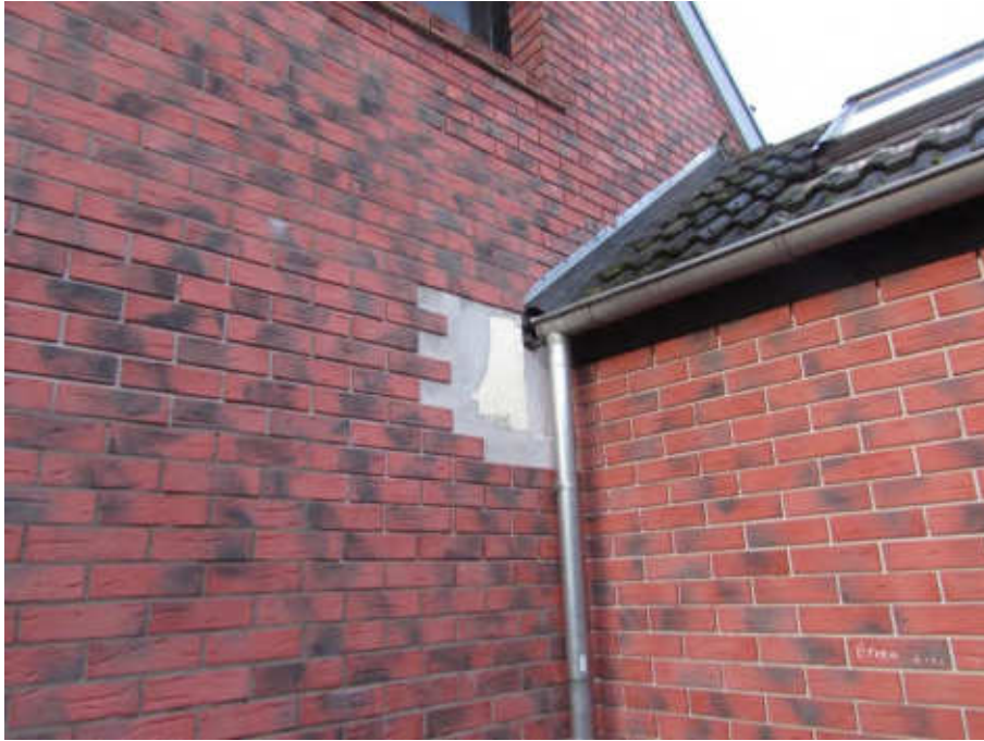
Foto 9: fehlende Klinkerriemchen (Wohnhaus)
