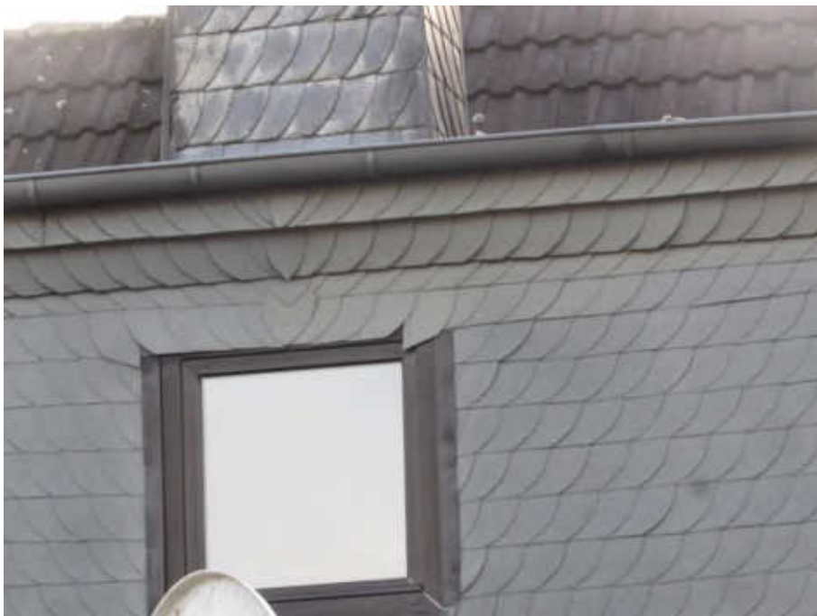
Foto 14: lose Verkleidung im Bereich der Dachgaube (Wohnhaus)
