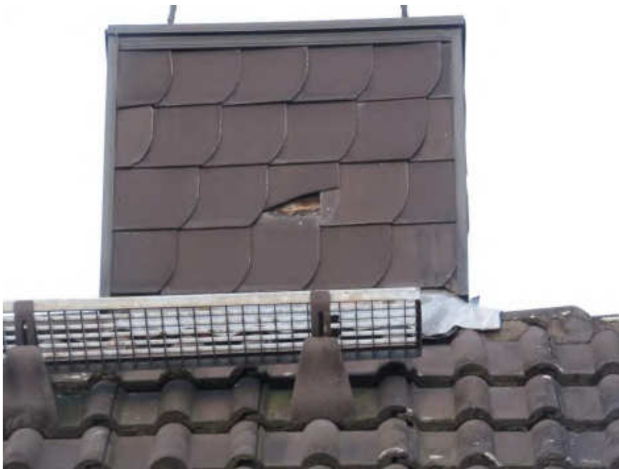
Foto 10: beschädigte Schornsteinverkleidung (Wohnhaus)
