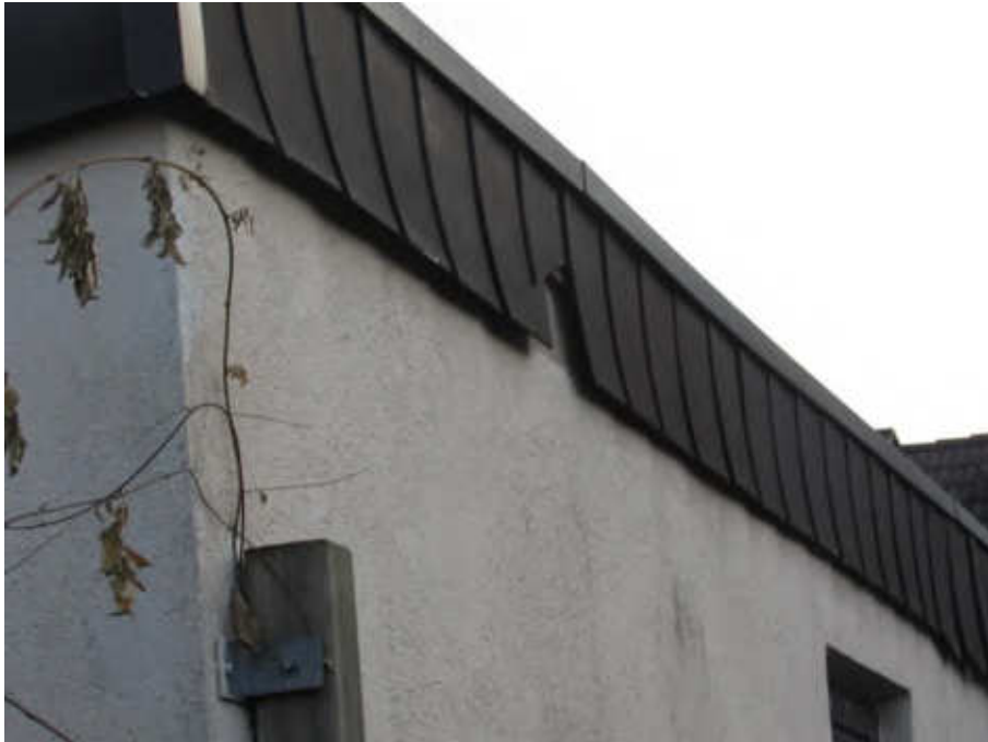
Foto 13: beschädigter Dachabschluss (Anbau II)
