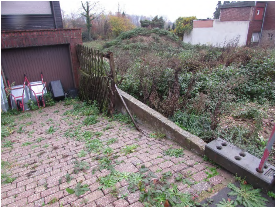
Foto 10: Zufahrt, schadhafter Holzjägerzaun
