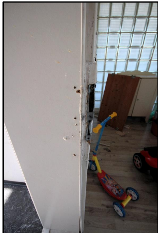
Bild 18: beschädigte Falle der Wohnungseingangstür zur WE Nr. 11
