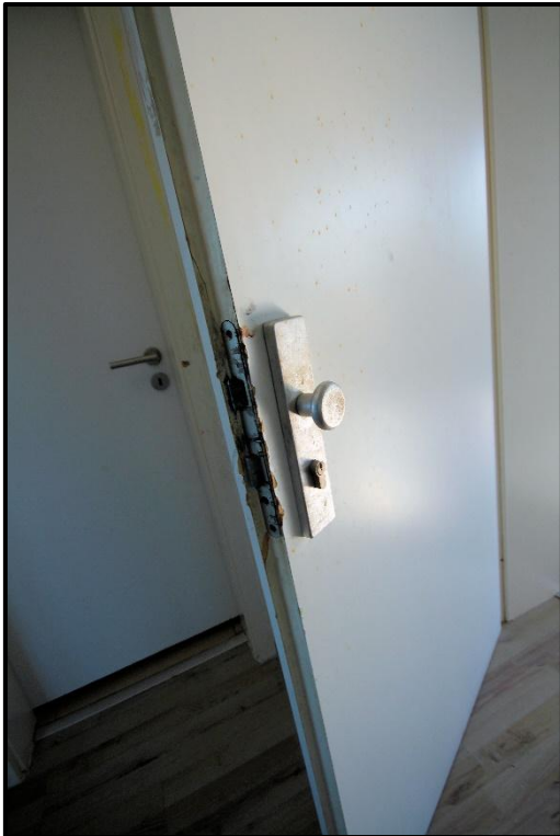
Bild 19: beschädigtes Türblatt der WE Nr. 11
