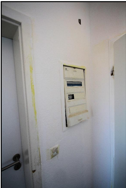
Bild 21: Sicherungskasten im Flur der WE Nr. 11
