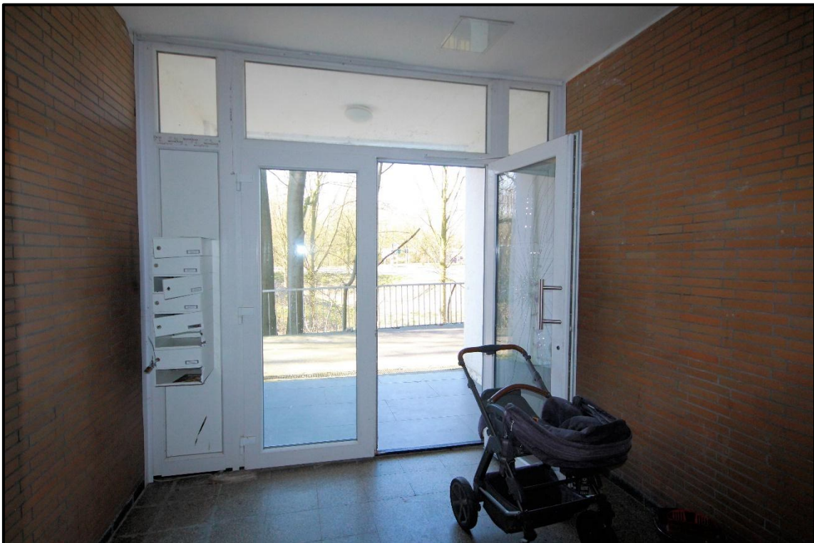
Bild 14: wie vor, mit Blick auf die beschädigten Briefkästen und die beschädigte Haustür
