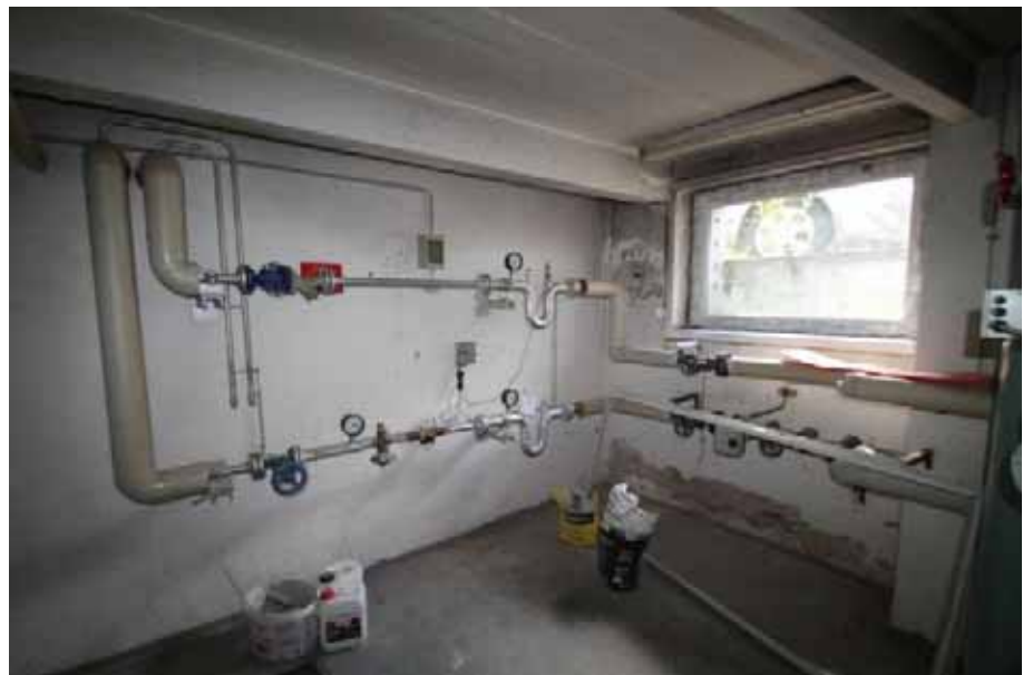
Sicht auf die Übergabestation / KG
