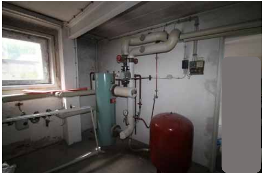
Sicht auf die Übergabestation / KG
