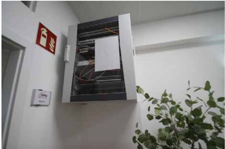
Sicht auf einen Sicherungskasten / 2. OG links
