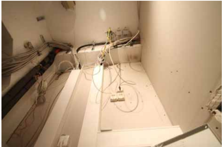
Sicht in den Server- /Unterverteilungsraum / 1. OG
