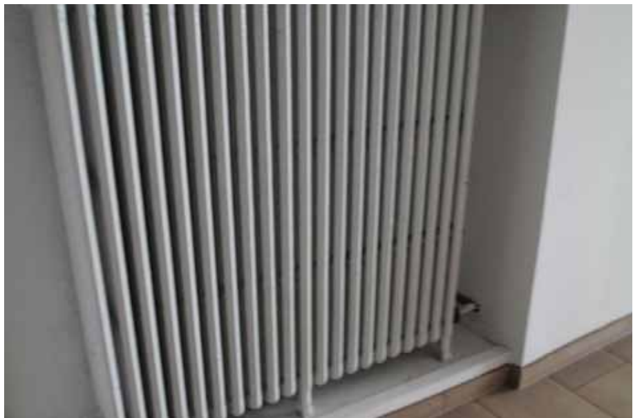
Sicht auf den Heizkörper im Flur des Eingangsbereichs / EG
