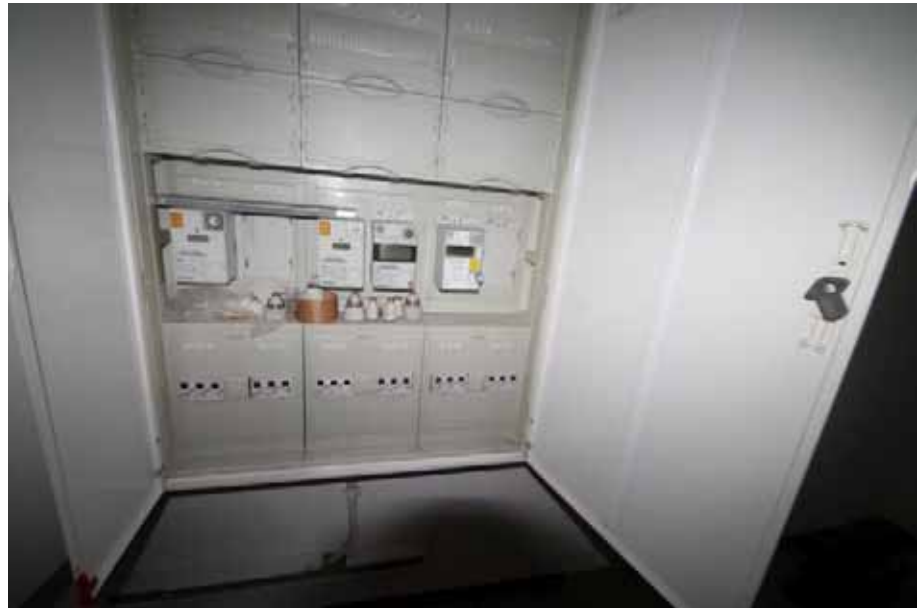
Sicht in einen Sicherungs- und Zählerkasten / KG
