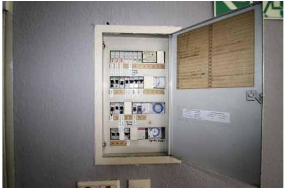
Sicht in einen Sicherungskasten / EG
