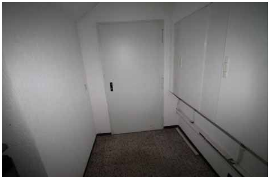
Sicht auf die Tür zum Kellergeschoss (fehlender Türgriff) / KG
