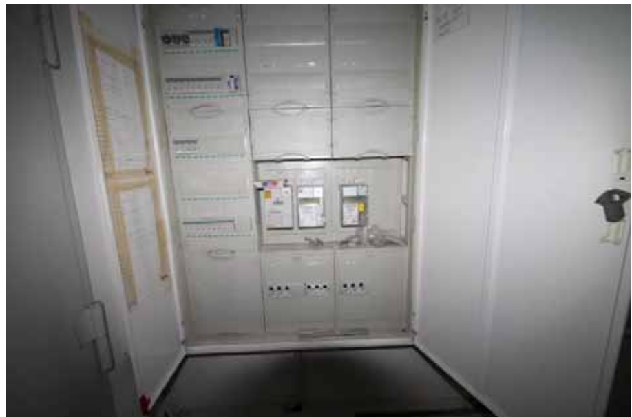
Sicht in einen Sicherungs- und Zählerkasten / KG
