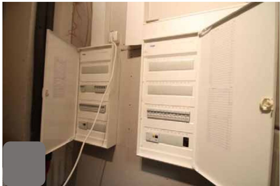
Sicht in die Siche- rungskästen / 1. OG
