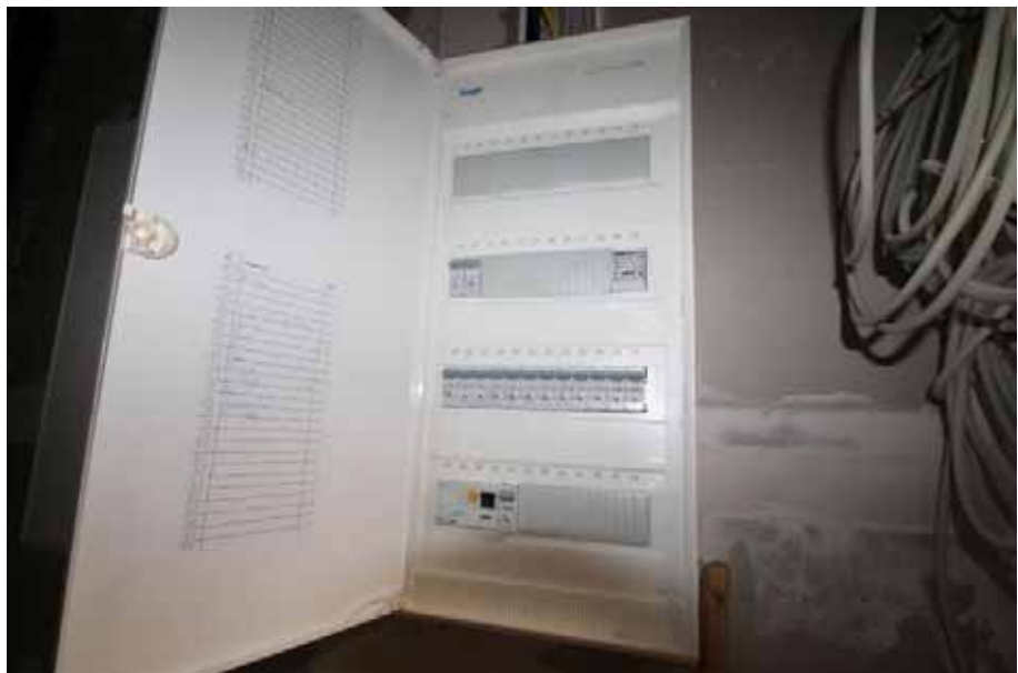
Sicht in einen Sicherungskasten / 2. OG rechts
