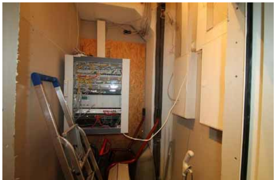
Sicht auf den Server der Mieterin / 1. OG
