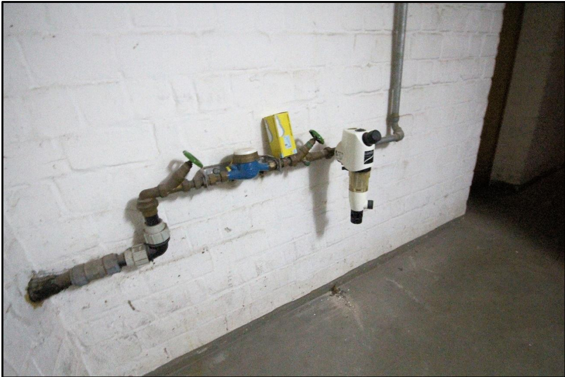
Bild 17: Frischwasseranschluss mit Filteranlage im Kellerflur
