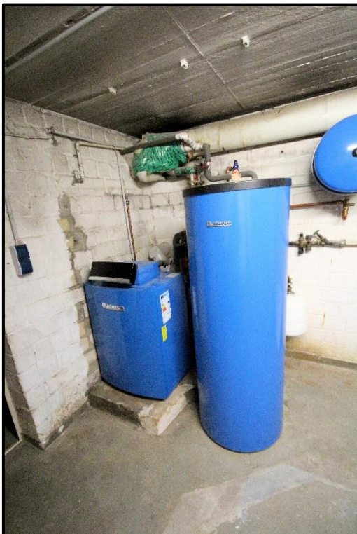
Bild 15: angemietete Heizungsanlage der Stadtwerke Haltern am See GmbH
