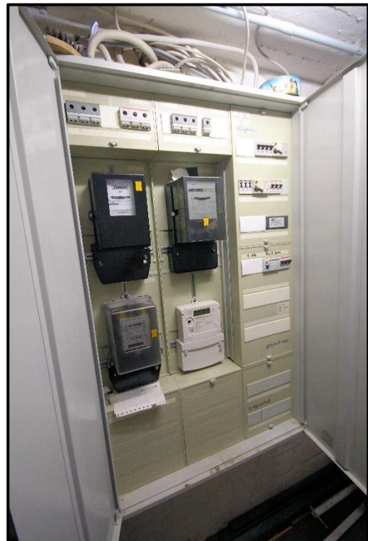
Bild 16: Zähler- und Sicherungsschrank im Kellergeschoss
