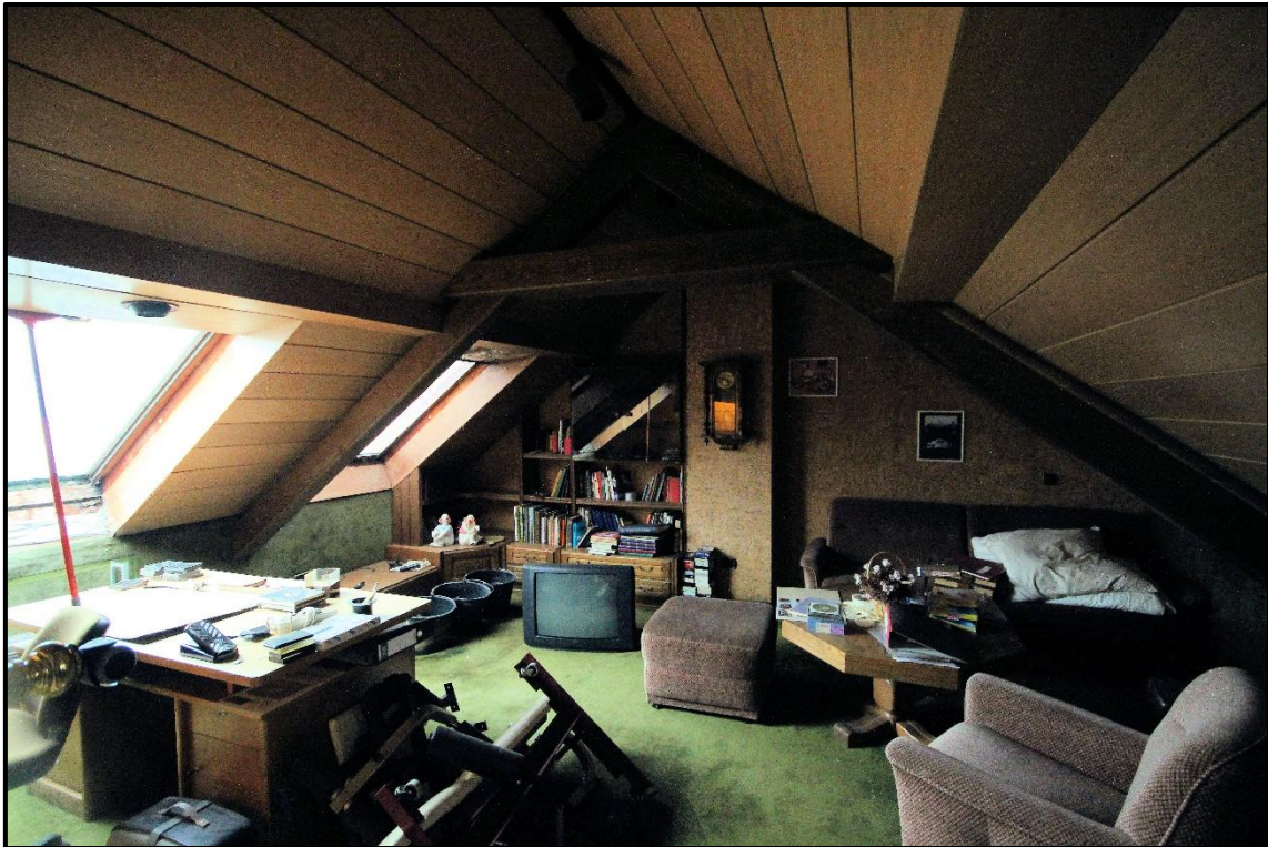
Bild 44: Wohnraum im DG mit defekten Dachflächenfenstern
