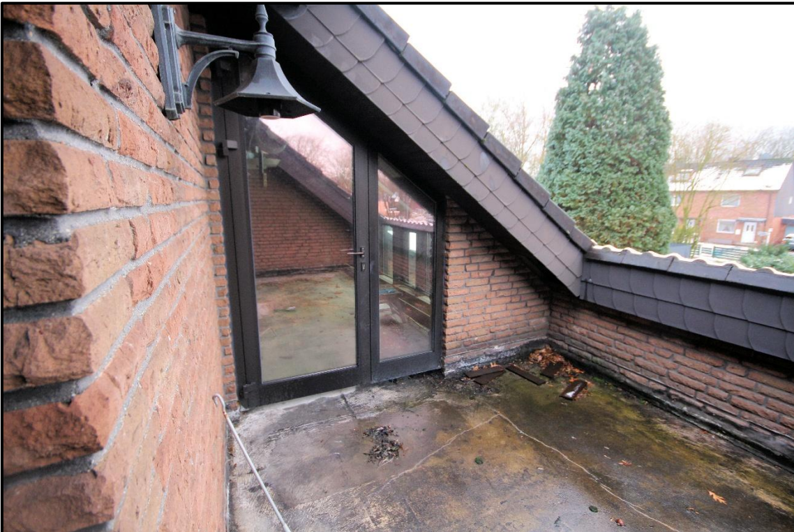
Bild 37: schadhafte gartenseitige Dachterrasse
