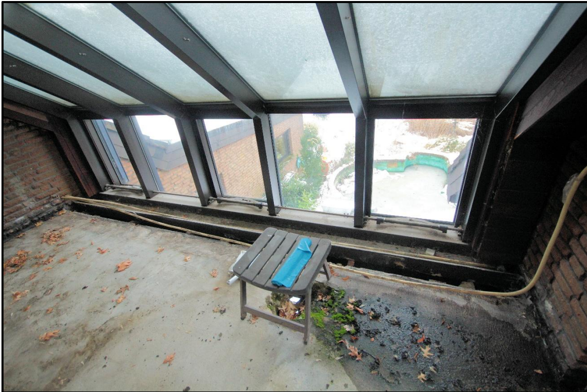
Bild 38: schadhafter gartenseitiger Wintergarten
