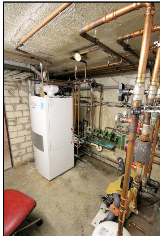
Bild 17: Gasheizung mit Warmwasserspeicher im Kellergeschoss
