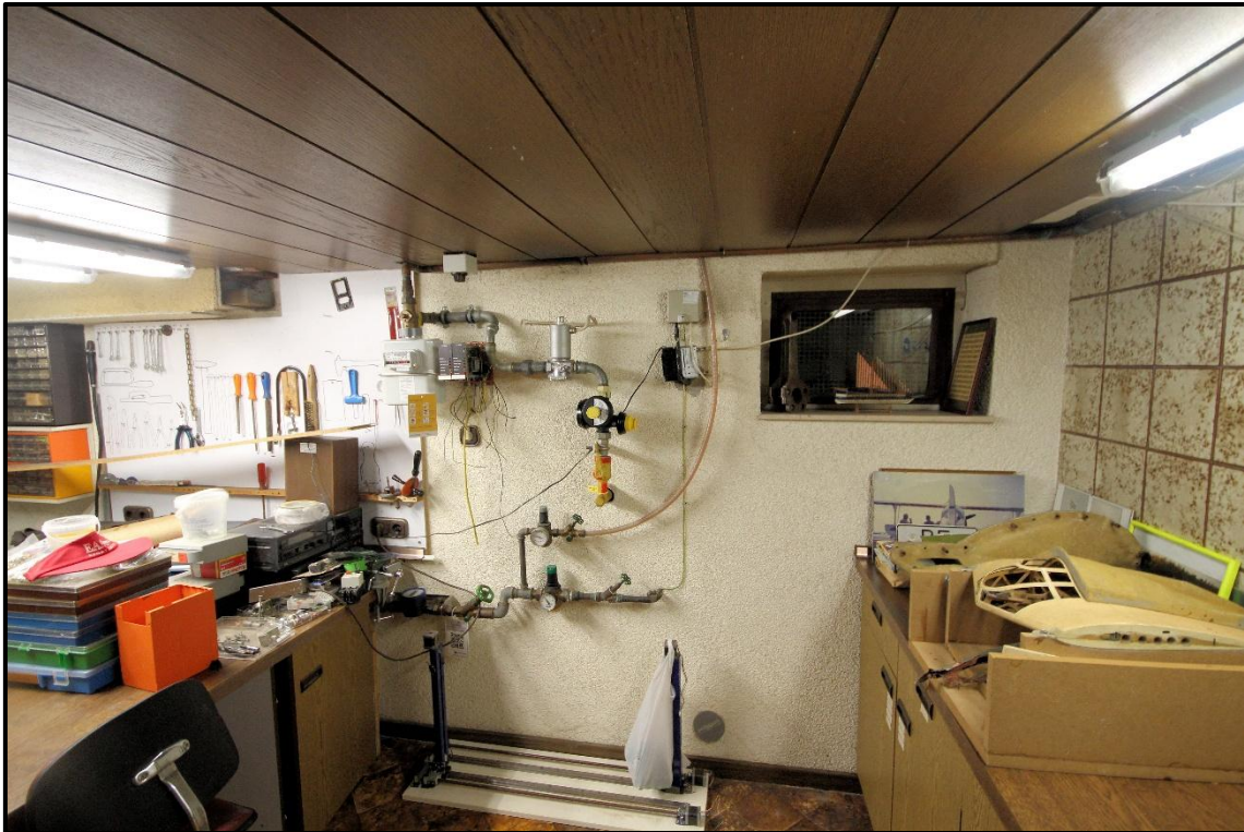
Bild 20: Kellerraum mit Hausanschlüssen für Frischwasser, Gas und Telefon
