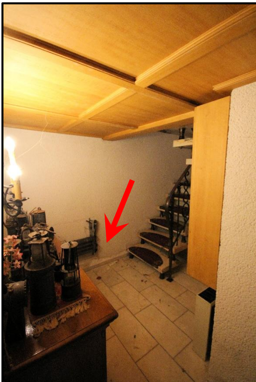
Bild 16: Kellerflur mit Feuchtigkeitsschaden an einer Außenwand
