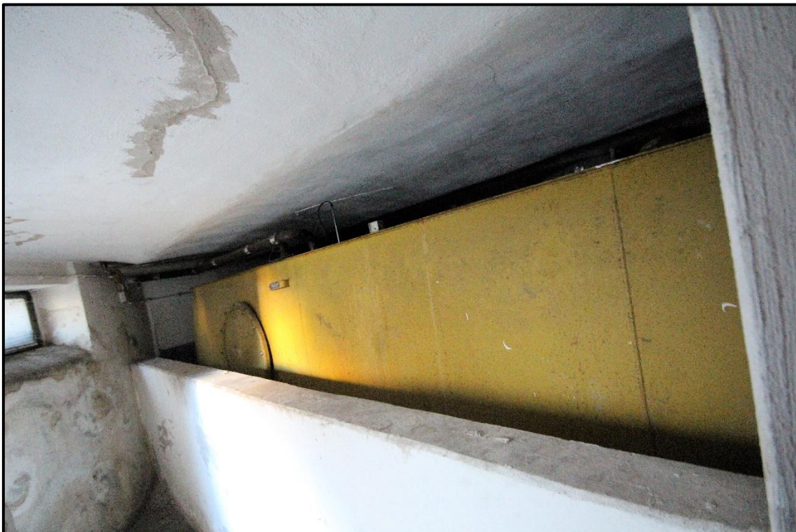
Bild 27: Heizöltank im seitlichen Nebengebäude
