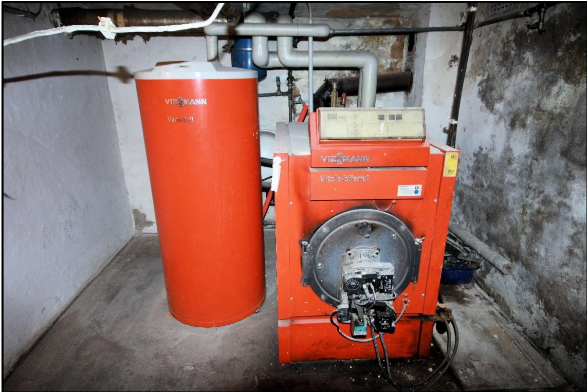
Bild 28: Öl-Heizungsanlage im seitlichen Nebengebäude
