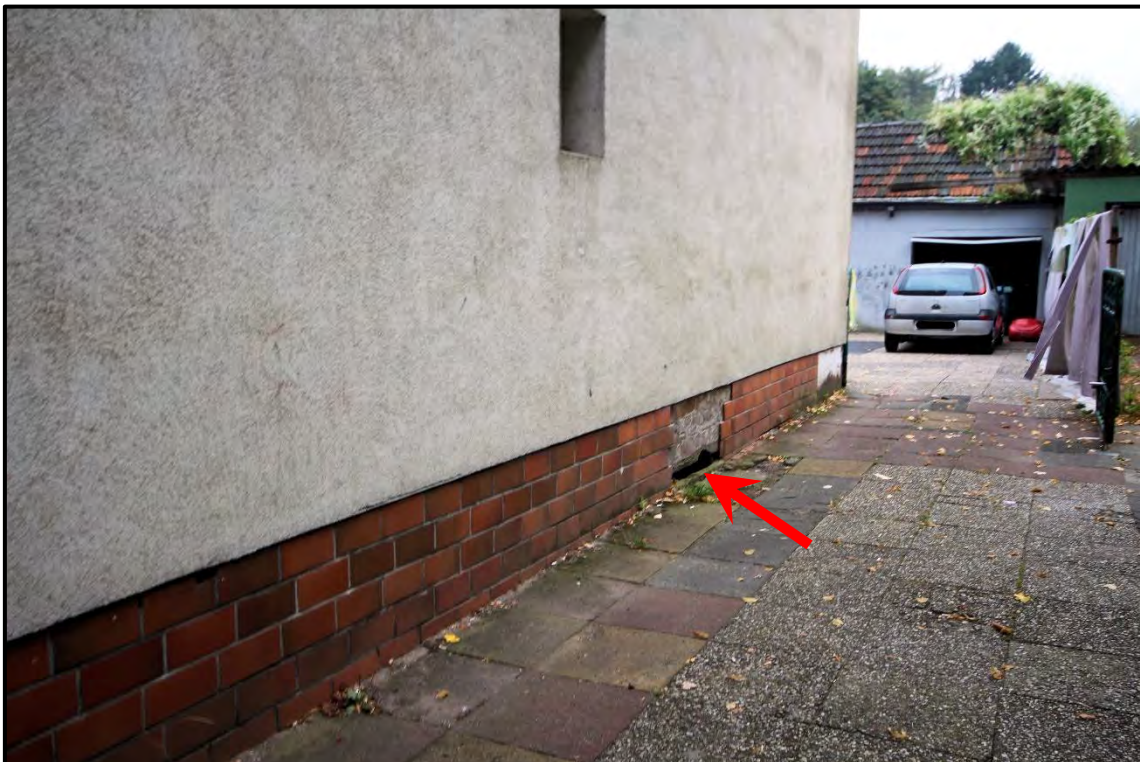
Bild 10: Sockelschaden an der Giebelwand
