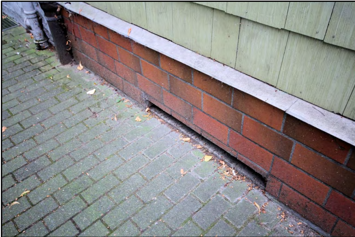
Bild 9: fast geschlossenes Kellerfenster
