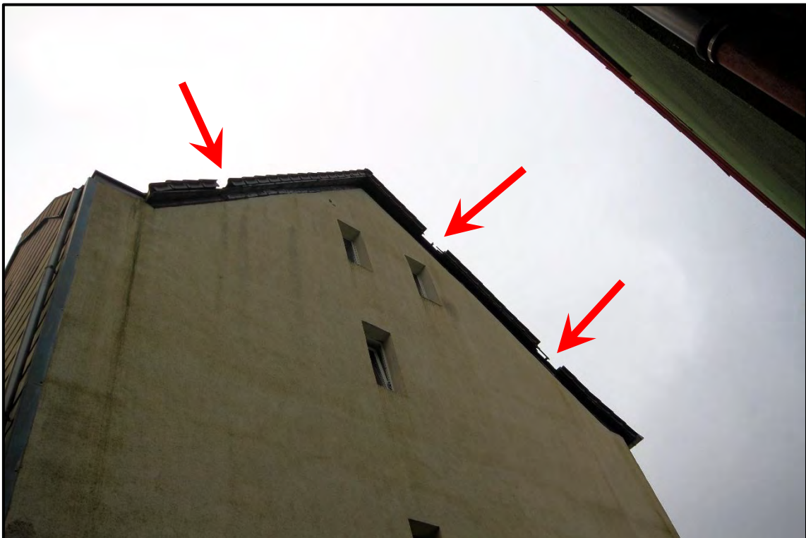
Bild 12: Fehlende Ortgangpfannen und geschädigte Sparrenlage
