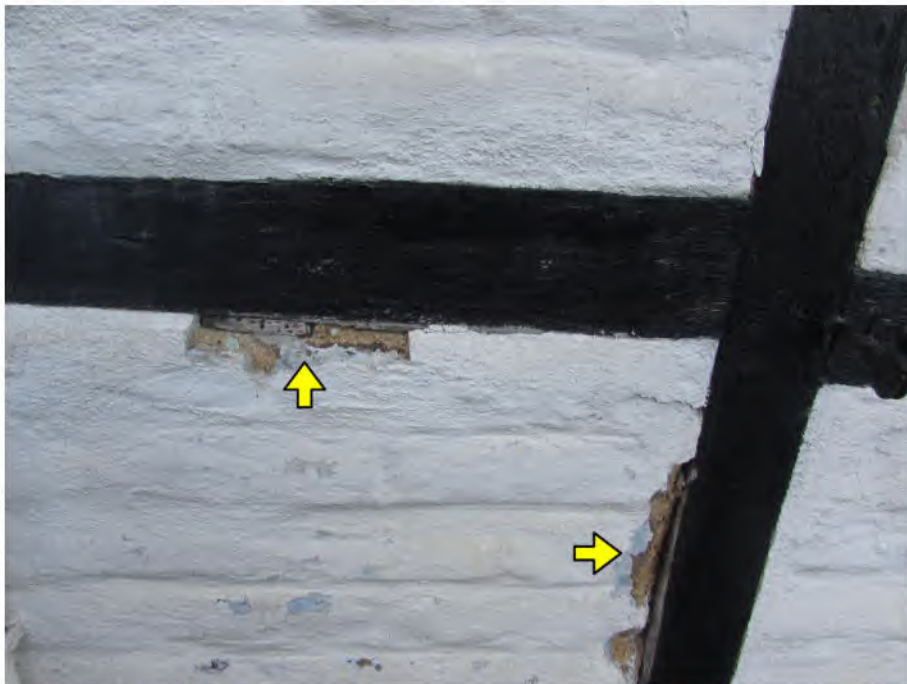
Foto 6: Beschädigungen/Abplatzungen im Fassadenbereich
