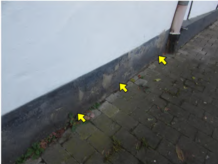
Foto 5: Feuchtigkeit im Fassadensockelbereich
