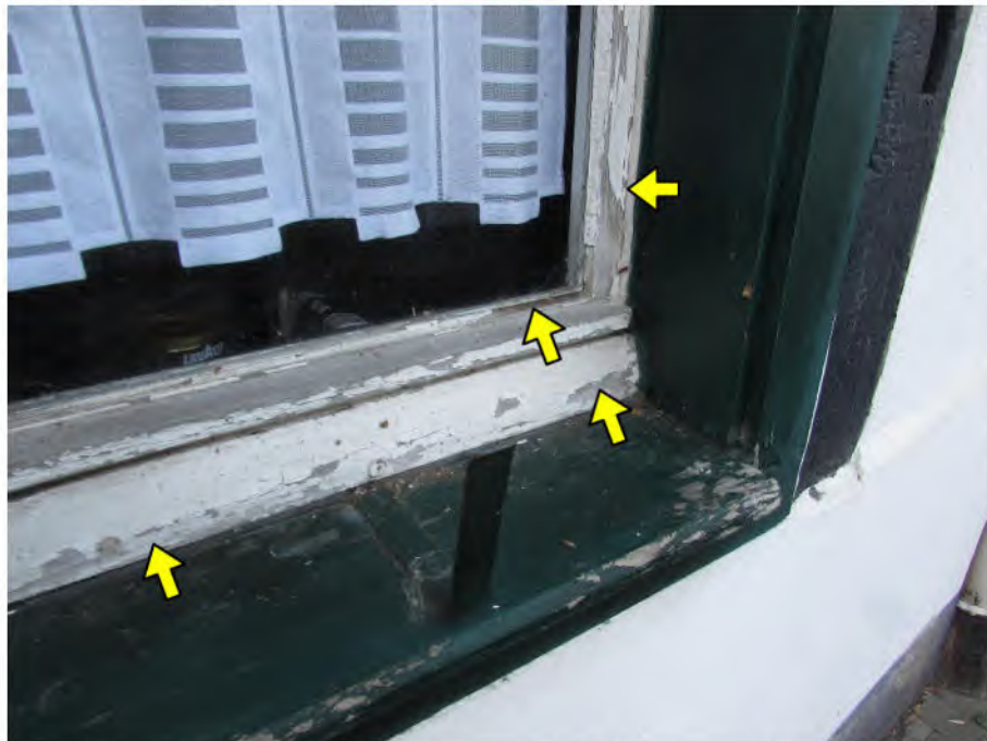
Foto 8: schadhafte und verwitterte, einfach verglaste Holzfenster
