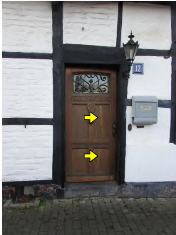
Foto 7: Hauseingang, gerissene Holztür
