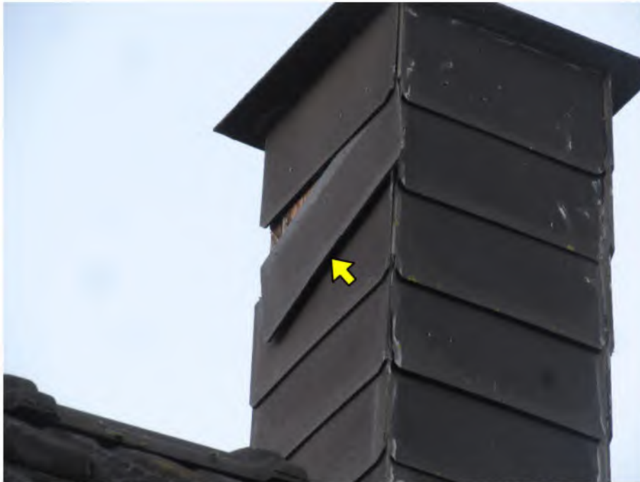
Foto 3: lose Faserzementplatten der Schornsteinkopfverkleidung
