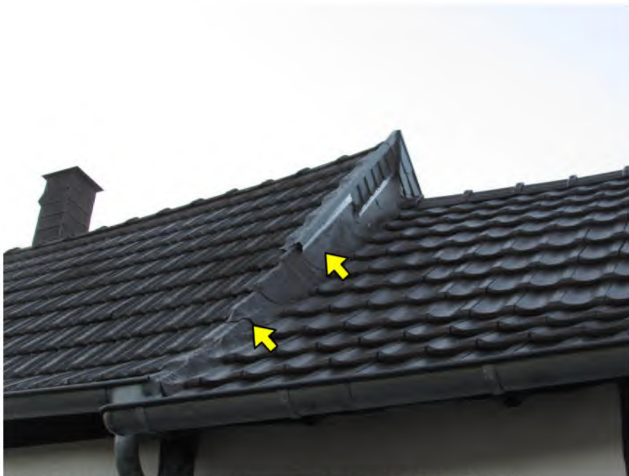
Foto 4: überprüfungsbedürftiger seitlicher Dachabschluss
