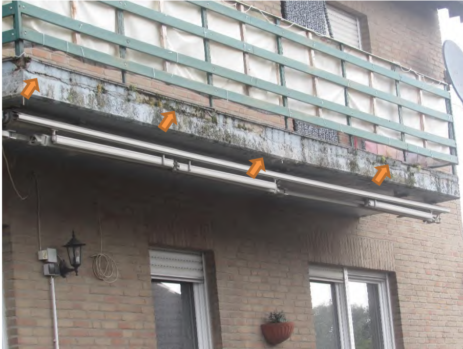
Foto 11: Wohnhaus, Risse und Beschädigungen sowie Feuchtigkeit an der auskragenden Betonplatte des Balkons
