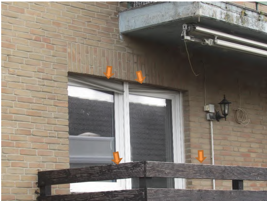
Foto 10: Wohnhaus, beschädigte Rollläden, verwittertes Holzbeländer der Erdgeschossterrasse
