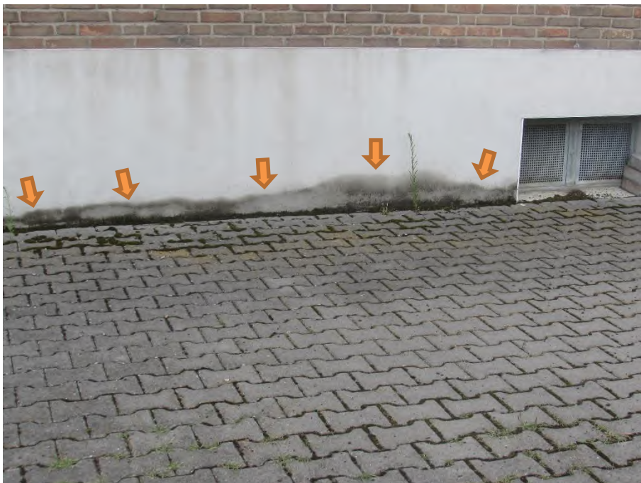
Foto 12: Wohnhaus, Feuchtigkeit im Sockelbereich
