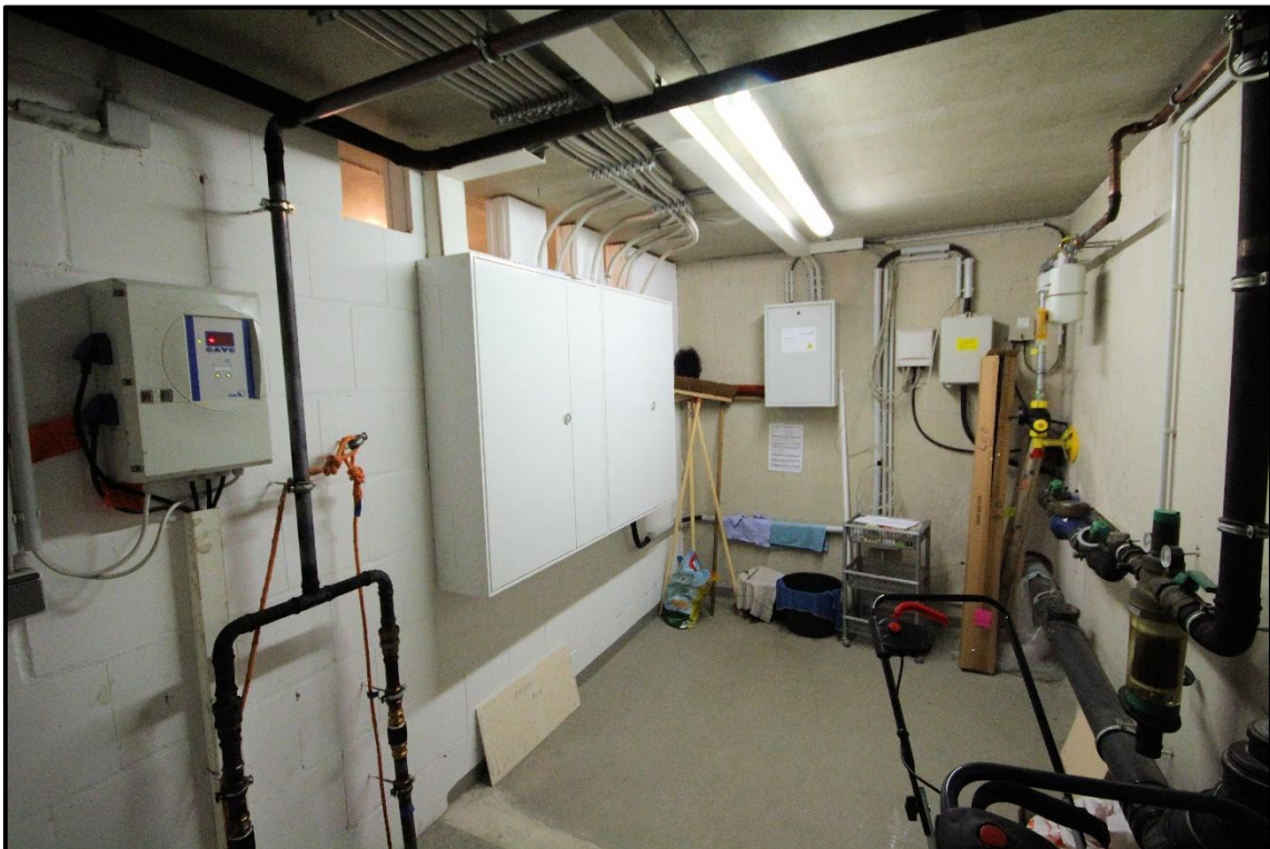
Bild 19: Hausanschlussraum im Kellergeschoss
