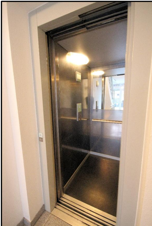
Bild 15: Aufzug vom KG bis DG
