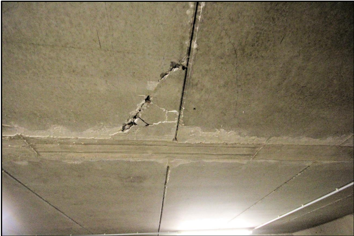
Bild 24: Betonschaden an der TG-Decke (wird als optischer Mangel angesehen)
