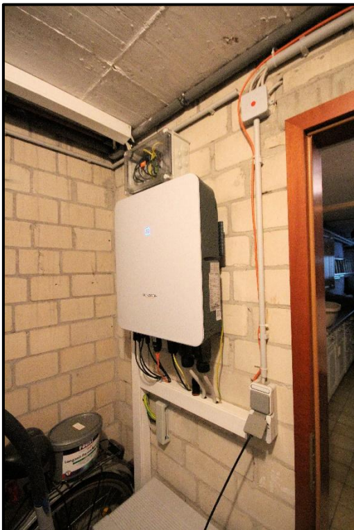
Bild 16: Gleichrichter der Photovoltaikanlage (Eigentum WE-Nr. 1)
