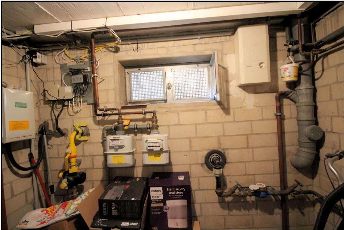
Bild 15: Weitere Anschlüsse (Gas, Telefon, Frischwasser) im Anschlusskeller
