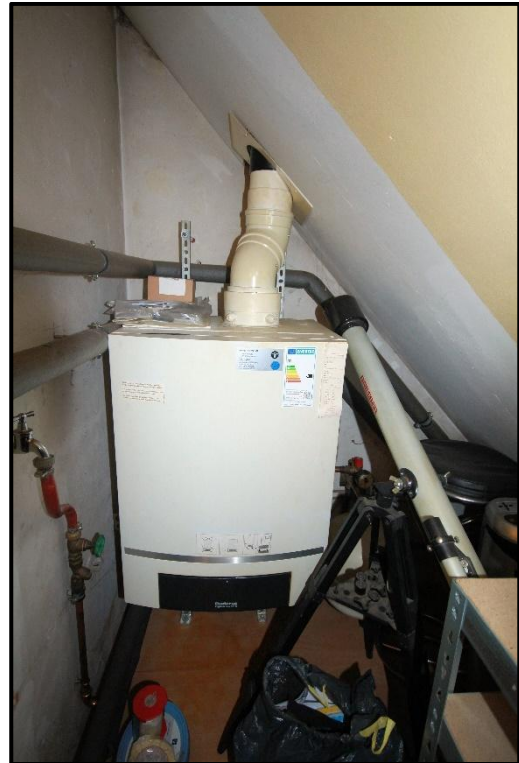
Bild 30: wie vor, mit Gas-Wärmeerzeuger
