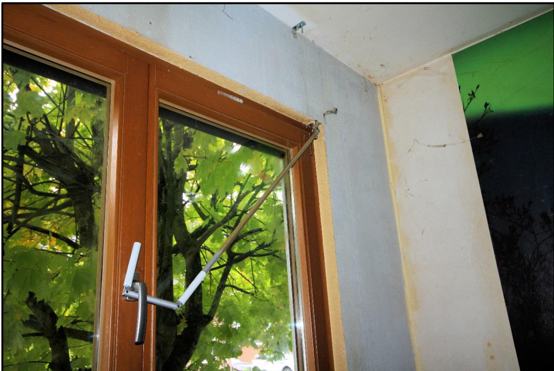
Bild 31: defektes Kurbelgestänge im Raum Kind 2 der Wohneinheit Nr. 1
