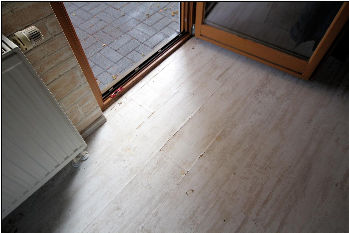
Bild 25: starke Gebrauchsspuren am Laminat zur Terrassentür
