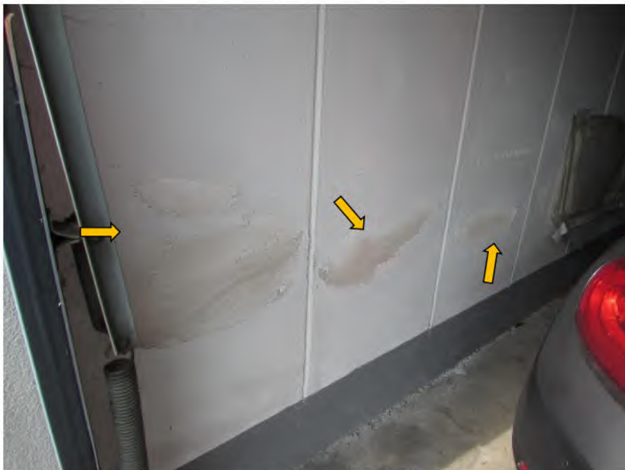
Foto 22: PKW-Fertigarage, Schäden und Feuchtigkeit im Wandbereich
