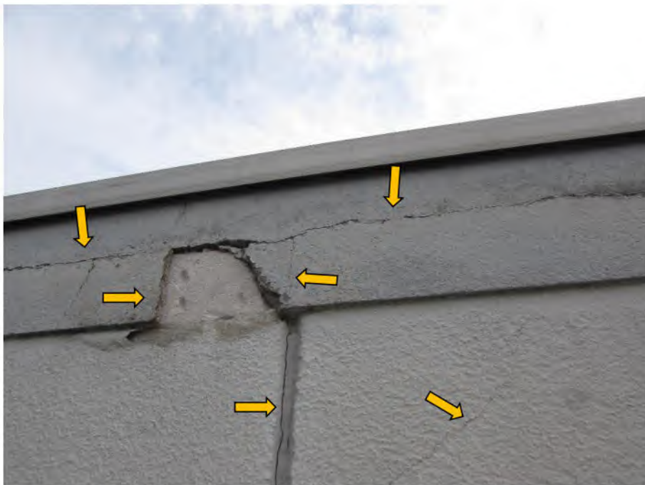
Foto 20: PKW-Fertigarage, Risse und Beschädigungen an der Fassade
