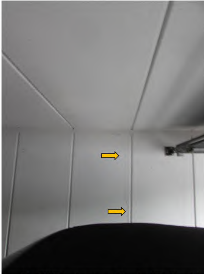
Foto 23: PKW-Fertigarage, Risse im Wandbereich
