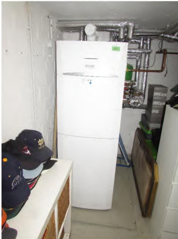
Foto 10: Wohnhaus, Kellergeschoss, Heizkessel
