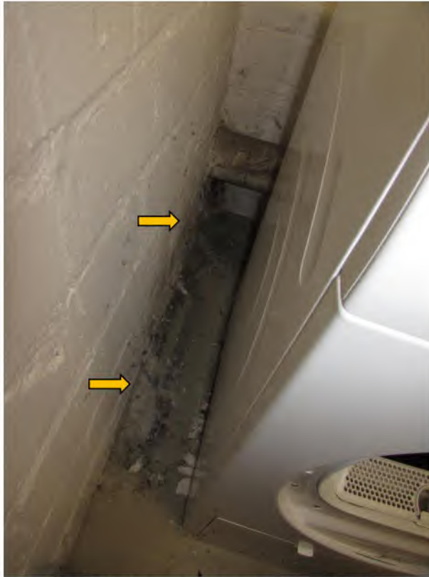
Foto 9: Wohnhaus, Kellergeschoss, leichte Feuchtigkeit im Wandbereich
