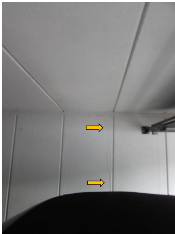
Foto 14: PKW-Fertigarage, Risse im Wandbereich
