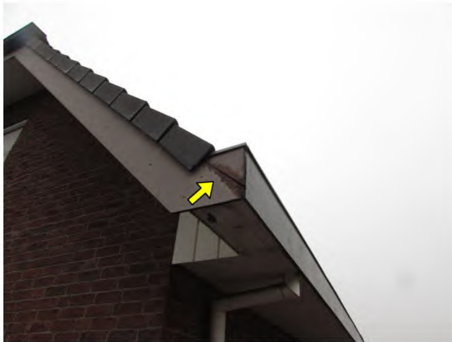
Foto 5: verwitterte Holzverkleidung der Dachrinne
