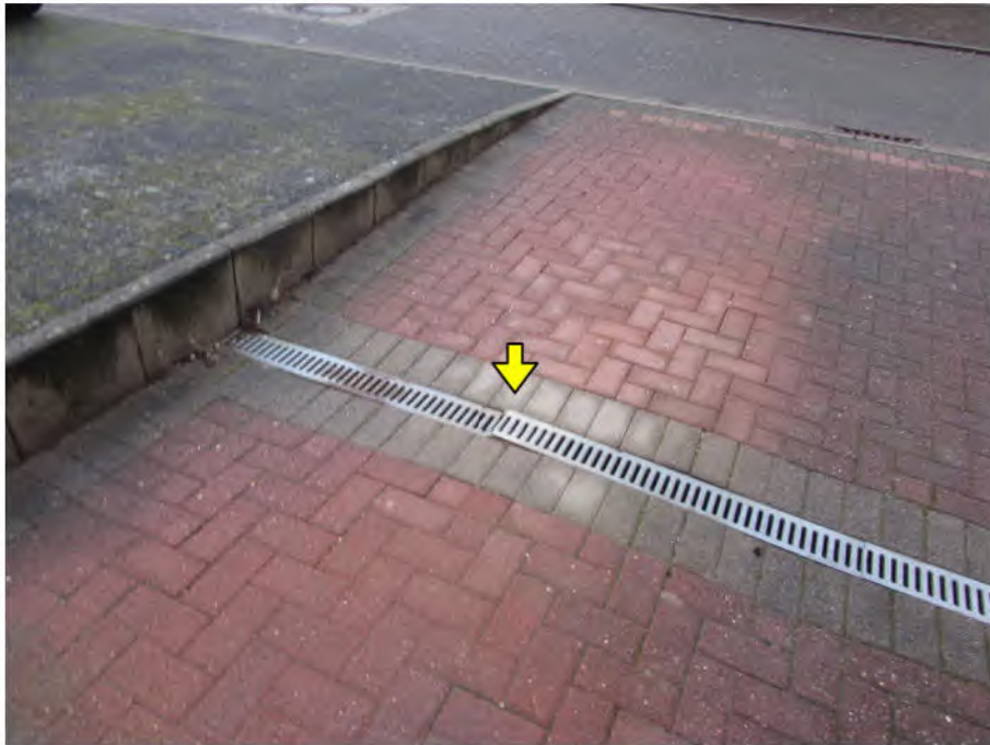
Foto 7: verbogene Gitterrostabdeckung der Aco-Entwässerungsrinne im Zufahrtsbereich
