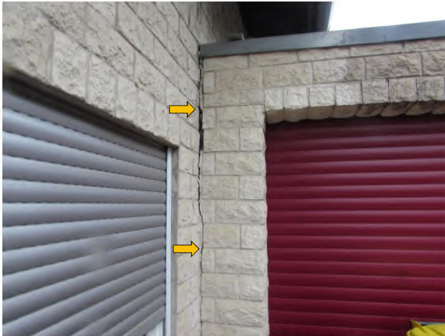
Foto 7: PKW-Garage, Risse im Wandanschlussbereich zum Wohnhaus
