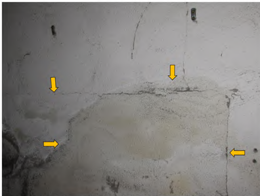
Foto 10: PKW-Garage, Feuchtigkeit und Risse im Wandbereich
