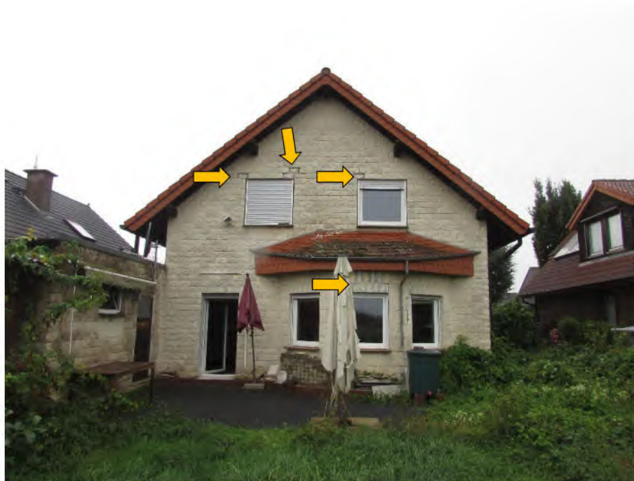
Foto 5: Wohnhaus mit PKW-Garage, Rückansicht, Schäden an der Fassade
