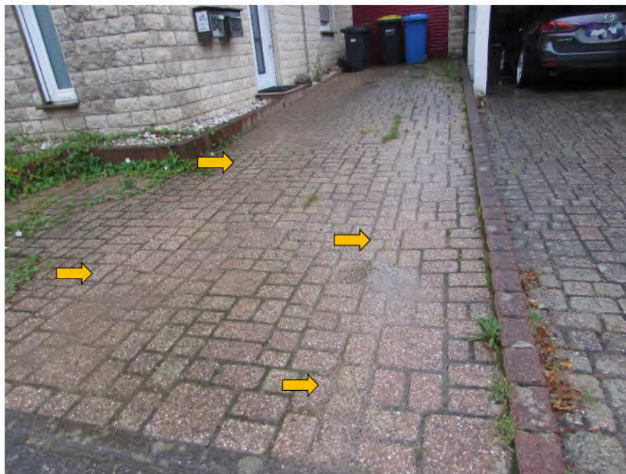
Foto 12: Zugang/Zufahrt, abgesetzte Betonpflastersteine
