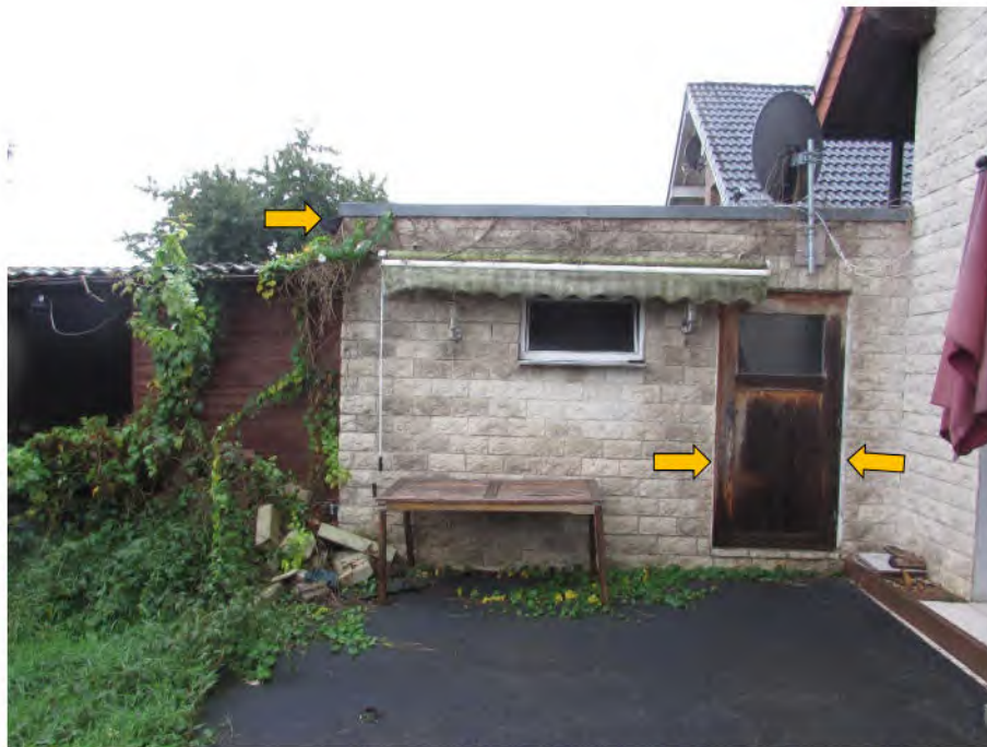
Foto 9: PKW-Garage, Seitenansicht, morsche Holztür, Bewuchs
