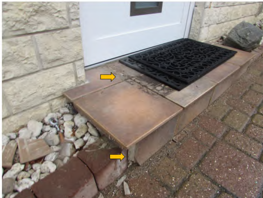
Foto 2: Wohnhaus, beschädigte Fliesen der Hauseingangsstufe
