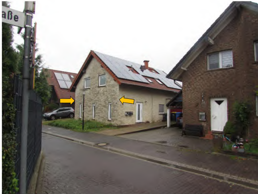
Foto 1: Wohnhaus, Straßen-/Seitenansicht, fleckige Fassade
