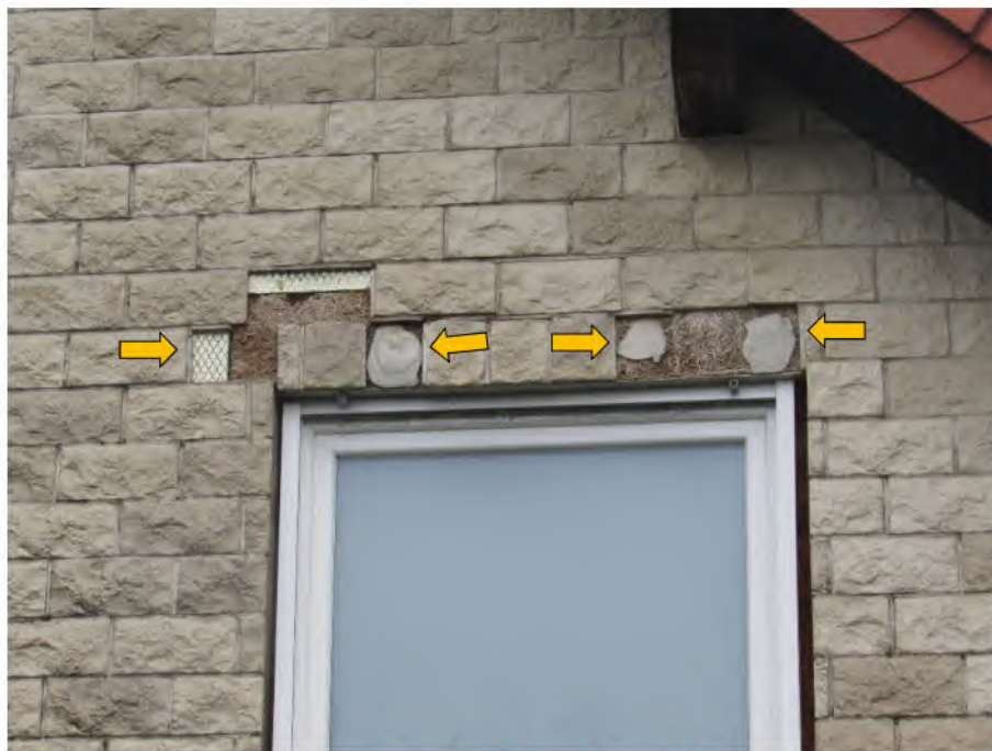
Foto 4: Wohnhaus, Schäden an der Fassadenverblendung
