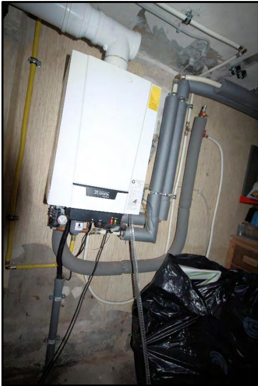
Bild 26: Gas-Heizungsanlage in einem hofseitigen Kellerraum
