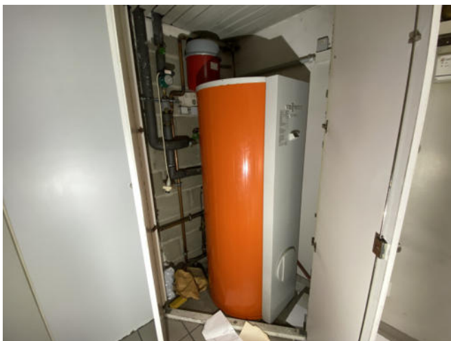
2.OG: Speicher - Wasserwärmer
