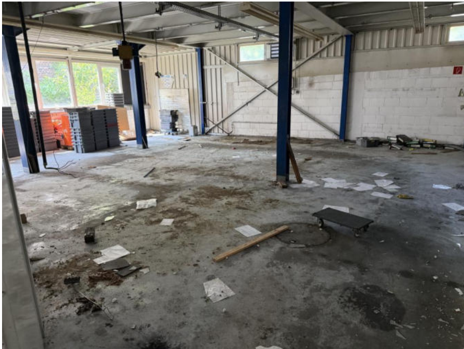
Foto 4: Produktion mit Abwasserschacht - Halle 3
