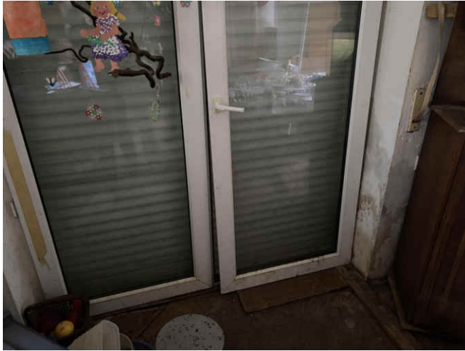
EG, Anbau, defekte Terrassentür
