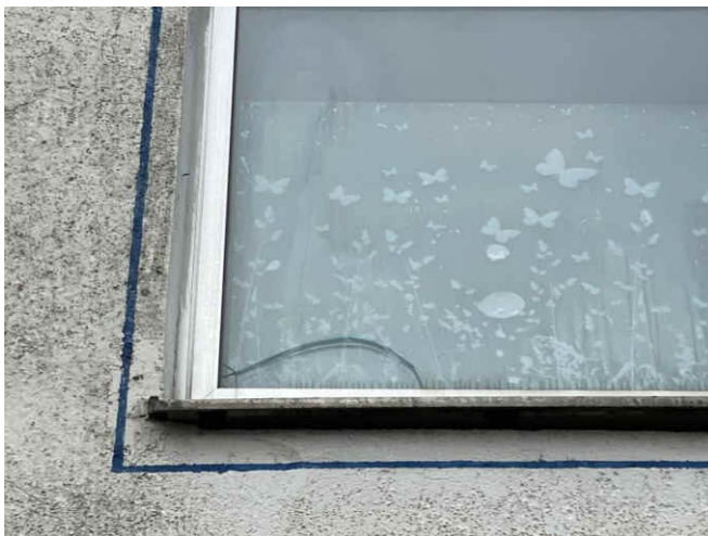
Altbau, beschädigtes Fenster
