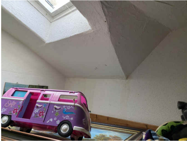
DG, Kind 1, Dachfenster, Feuchteschaden
