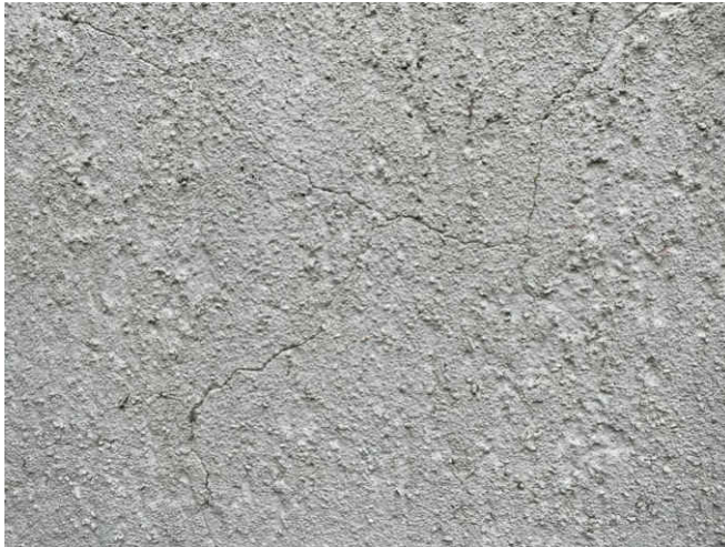
Fassade Altbau, Rissbildung
