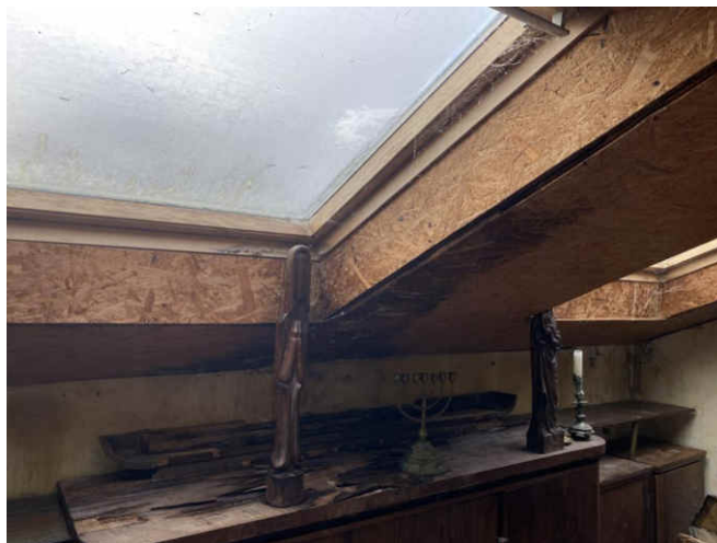
DG, Anbau, Dachfenster mit Feuchtigkeitsschaden
