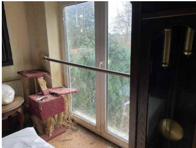
DG, Anbau, unzureichende Absturzsicherung
