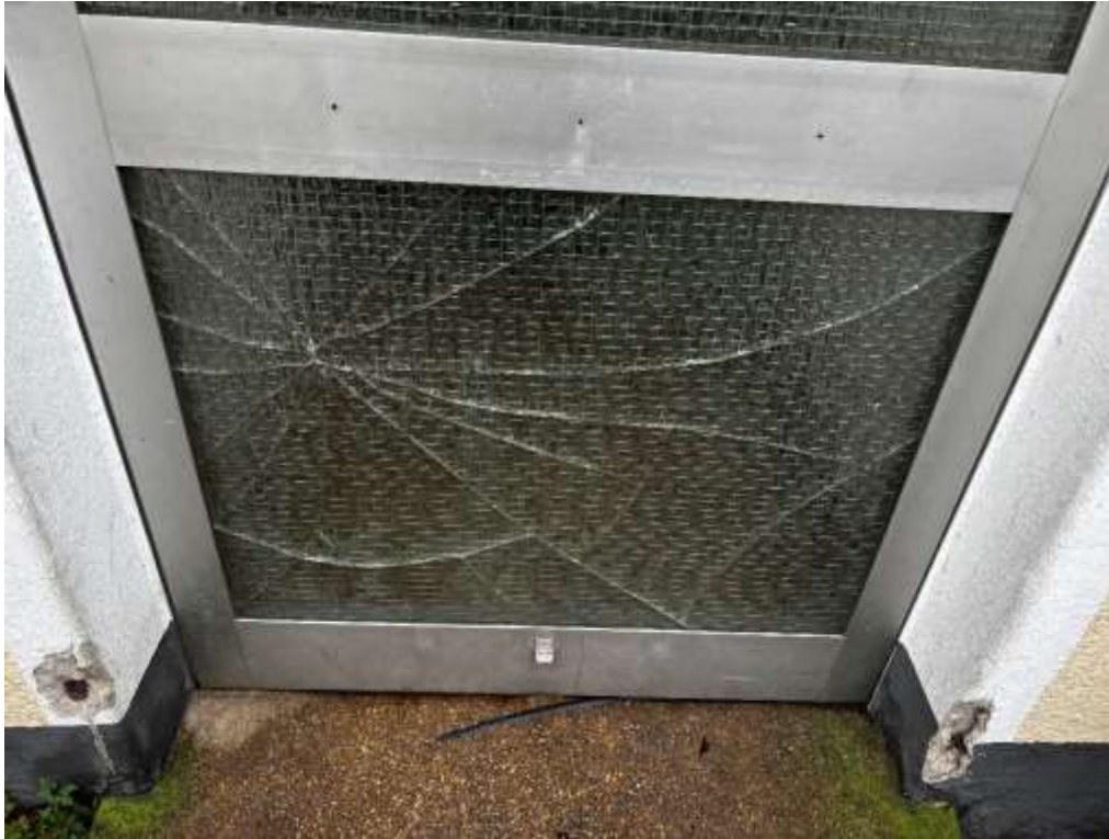
Hauseingang Giebelseite: defekte Scheibe in Hauseingangstür, Putzschäden
