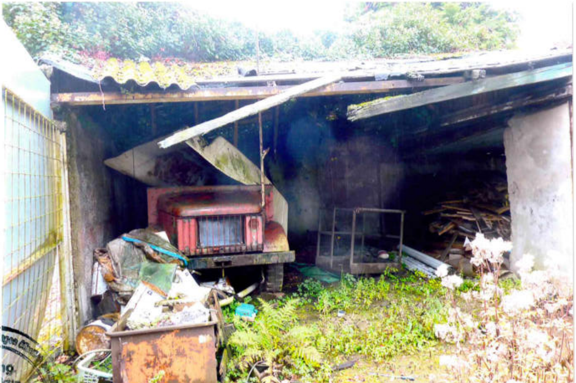
Bild 21 und 22 Eine Teilfläche der Dachkonstruktion des nahe der Straße „Am Alten Weg“ gelegenen Bereichs des Überdachungsbauwerks V ist eingestürzt.
