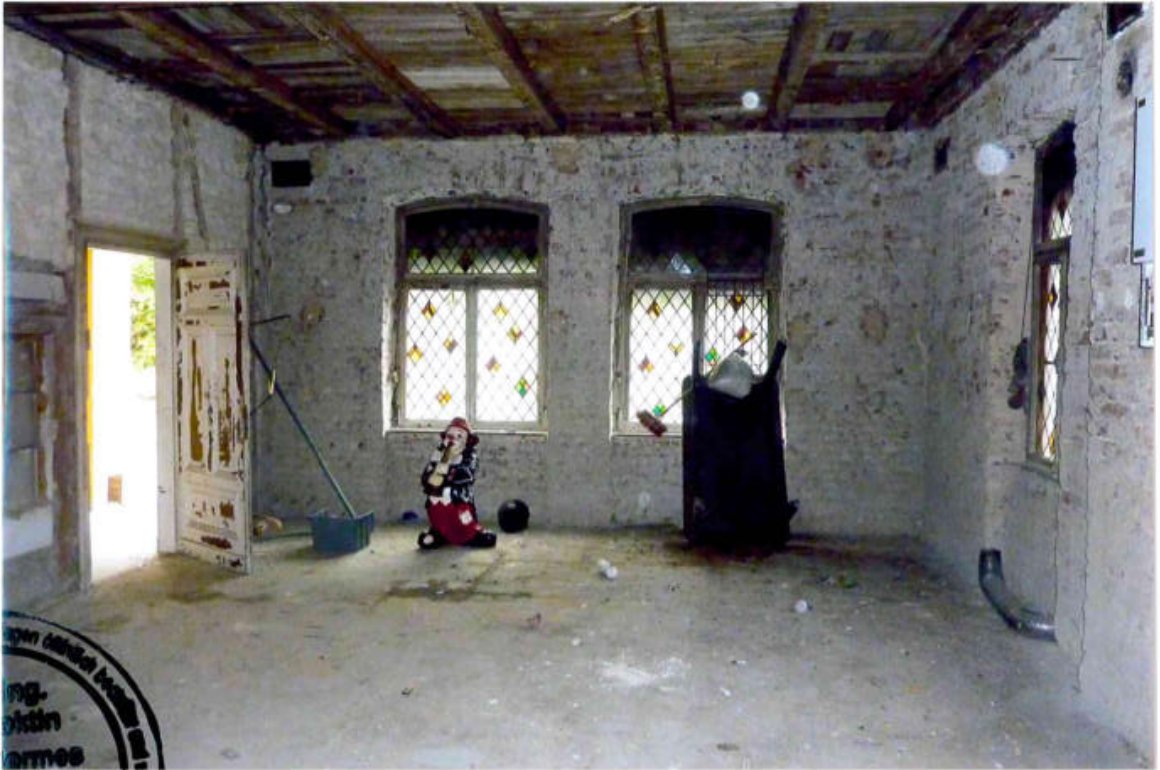
Bild 27 und 28 Der mit Eingangstür ausgestattete, als Gesellschaftzimmer 1 bezeichnete Raum sowie Blick durch den offenen Durchgang in Richtung Gesellschaftzimmer 2 und in das sich daran anschließende, rückseitig gelegene Gesellschaftzimmer 3
