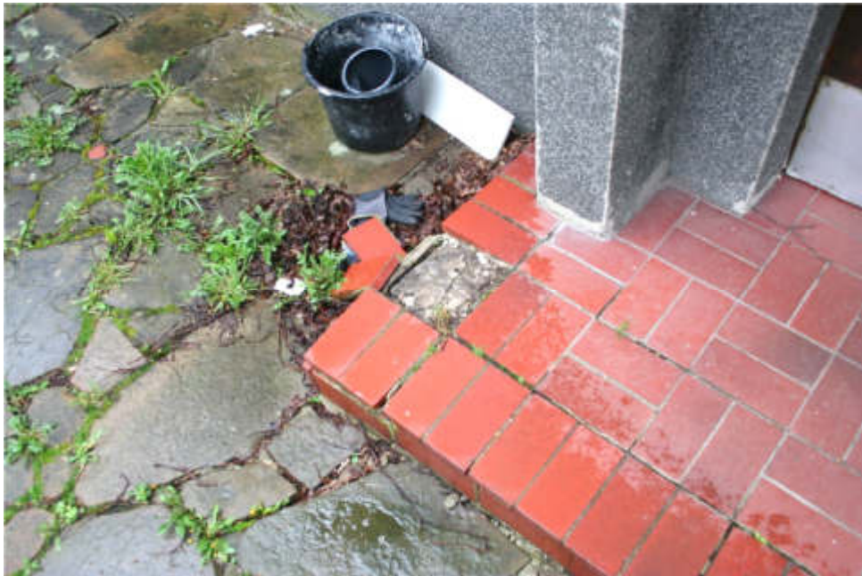
Bild 31: Detailfoto Abplatzungen Eingangsstufe
