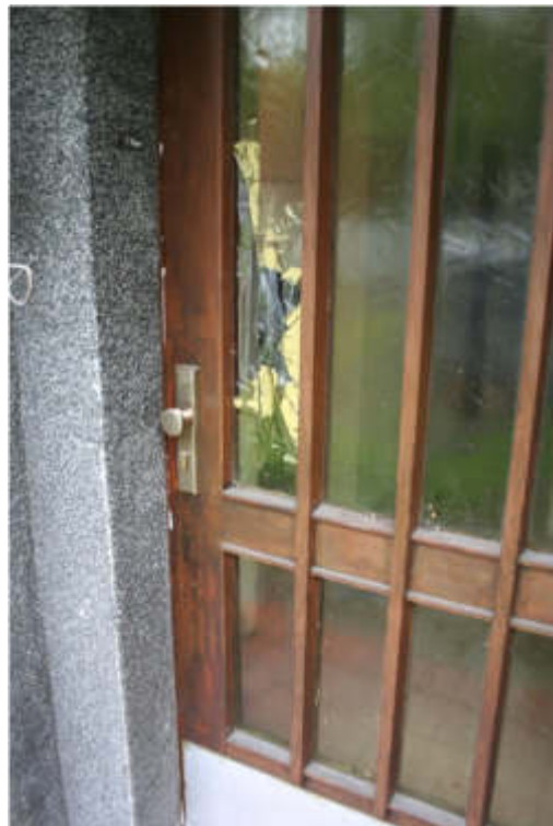
Bild 28: Hauseingangstür / defekte Scheibe
