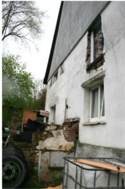
Bild 13: Südgiebel / Schäden Fassade erkennbar
