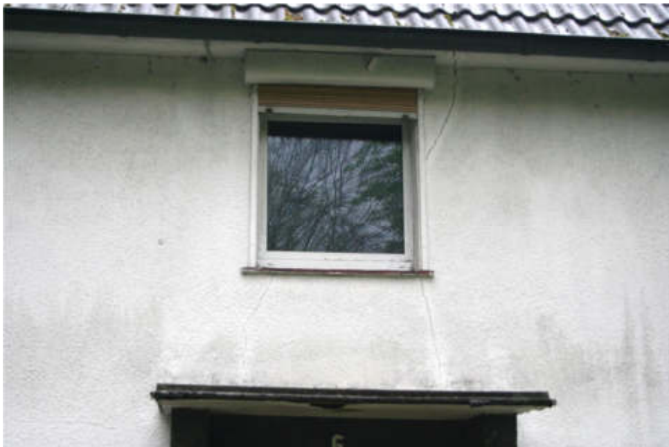
Bild 4: Rissbildungen in der Fassade
