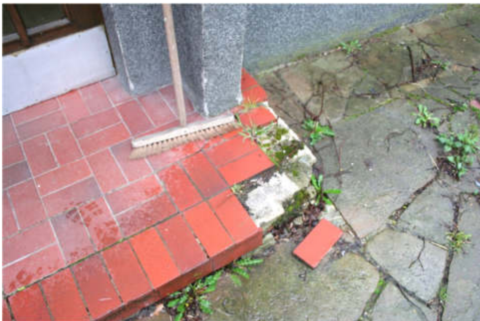
Bild 30: Detailfoto Abplatzungen Eingangsstufe
