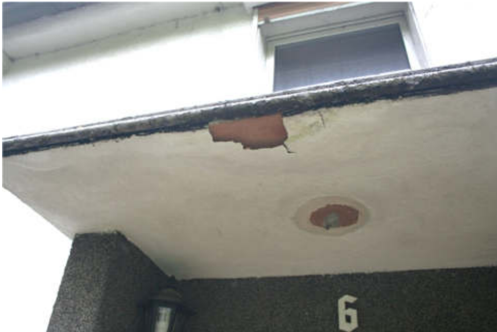
Bild 29: Detailfoto Schäden Eingangsüberdachung
