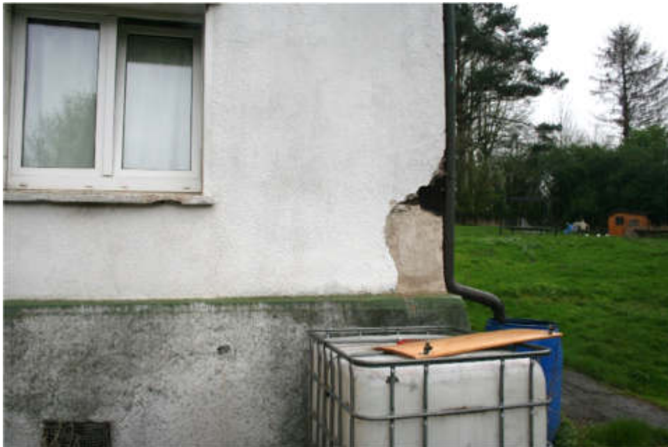
Bild 14: Detailfoto Schäden Fassade
