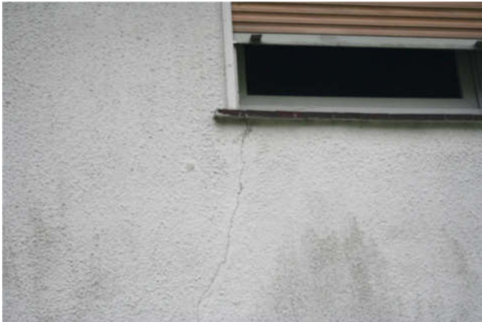
Bild 5: Detailfoto Rissbildungen in der Fassade
