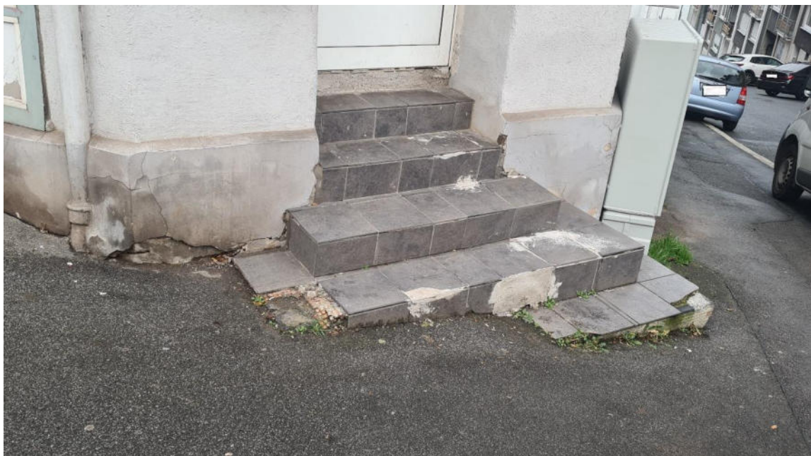
Bild 6: Detailfotos Schäden Treppe zum Ladenlokal im Eckbereich Eugen-Richter-Straße / Ewaldstraße
