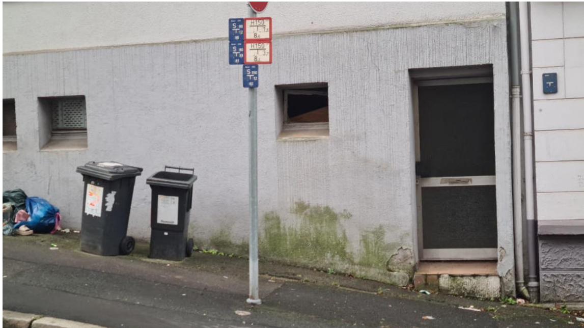
Bild 5: Kellerzugangstür an der Ewaldstraße / Feuchtigkeitsschäden in den Sockelbereichen
