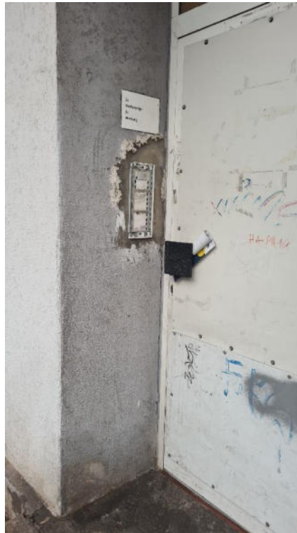
Bild 9: Hauseingangstür Eugen-Richter-Straße zu den Wohnungen / Tür- und Klingelanlage defekt
